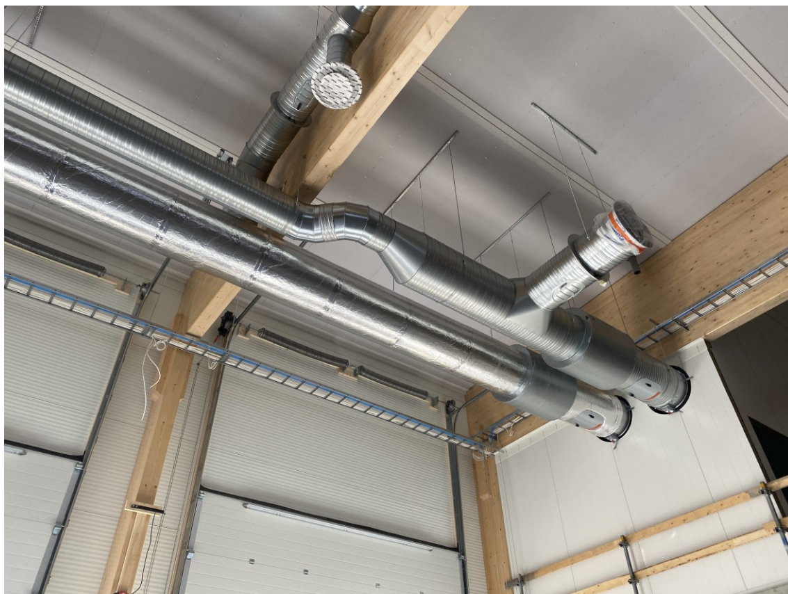
Kuva 11. Ilmanvaihtokanava liimapuupalkin alapinnassa, valaisinkisko asennetaan IV-kanavan alapuolelle. (Kuva: Rebecca Koivukoski 19.9.2020)
