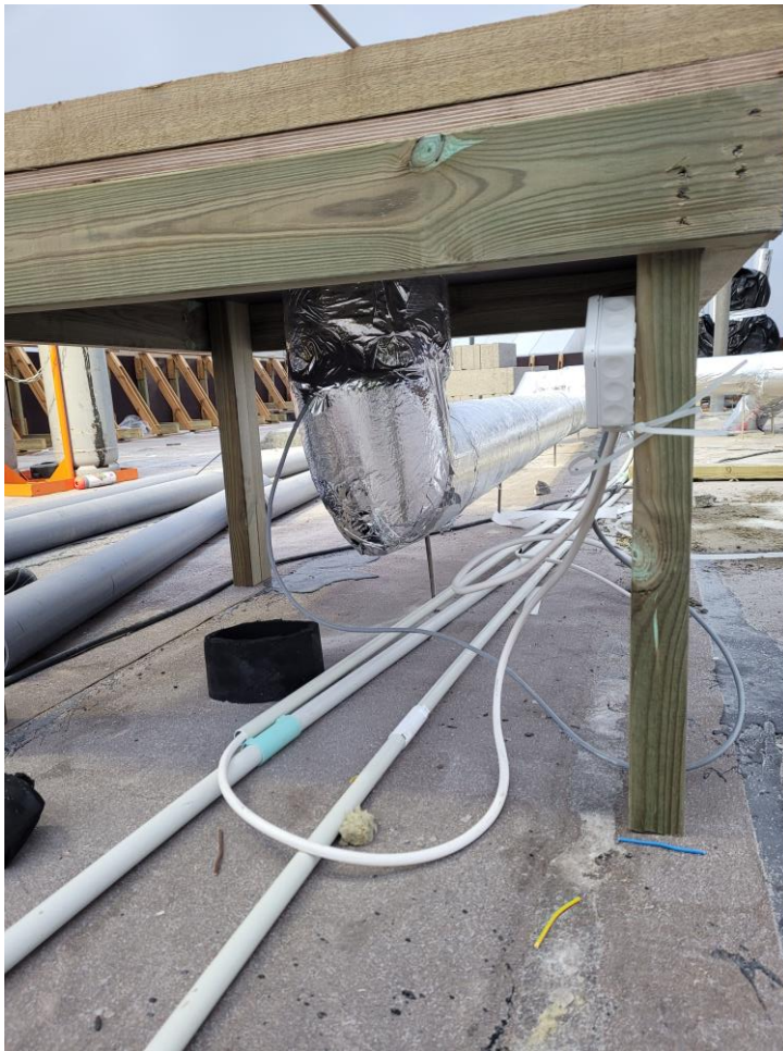
Kuva 15. Katolla sijaitsevan täyterroksen sähköasennus. [16.]
