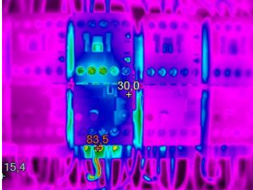
Kuva 8. Palaneen johtimen lämpökamerakuva. [6.]
