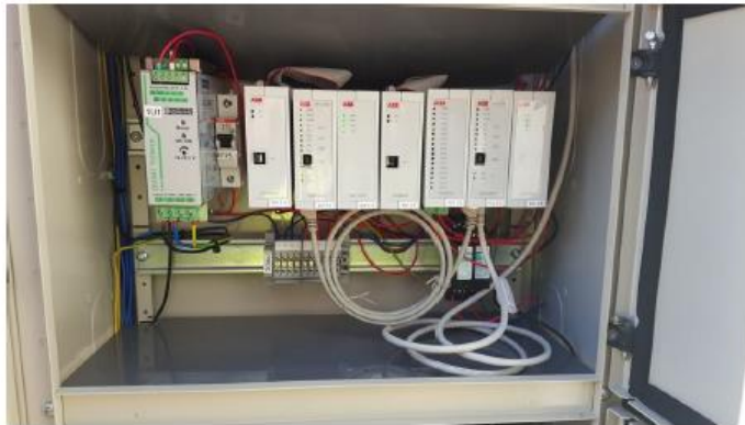
Kuva 2. Lämmitysmuuntajalle asennettavat RTU:t kuvassa näkyy 2 väylän ratkaisu.
