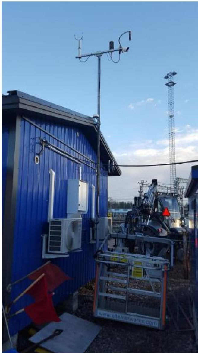
Kuva 3. Sääasema asennettuna sähköpääkeskuksen kylkeen.
