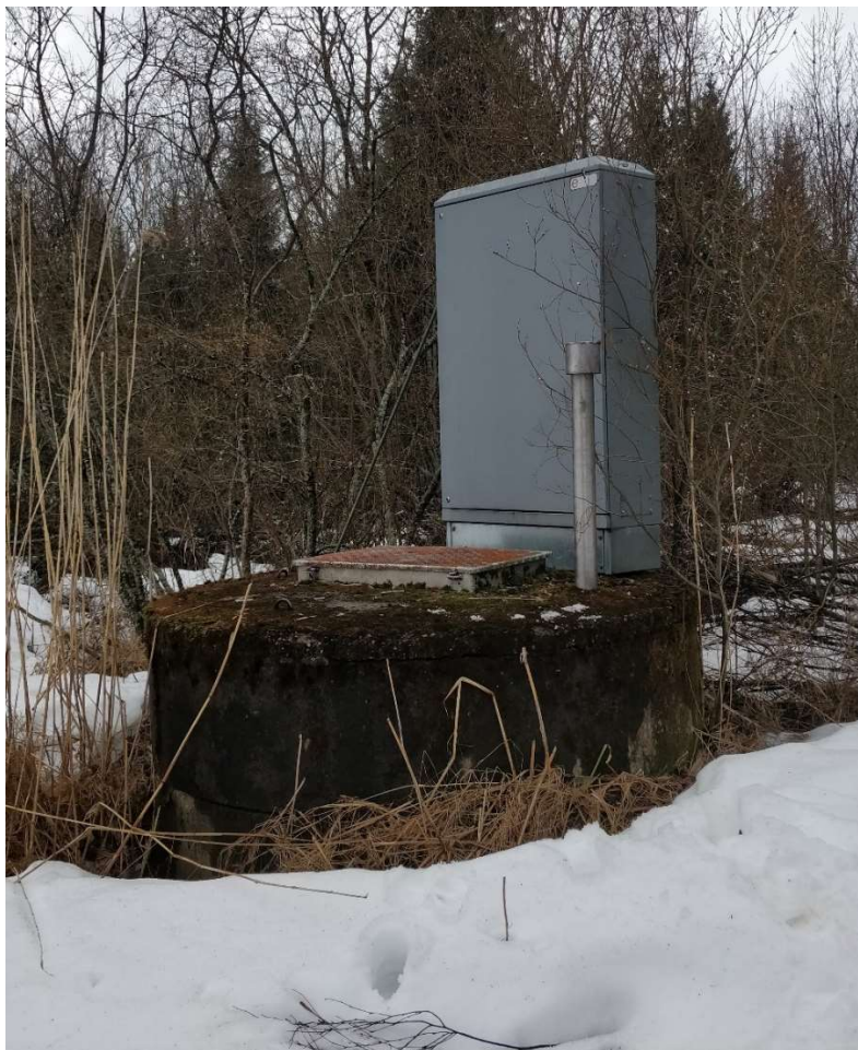
KUVA 6 Rantapumppaamo eli vedenottamo. Pumppu on uppoasennettu kaivoon noin 3–4 m:n syvyyteen. (Viherkoski 2021, CC BY-SA.)
