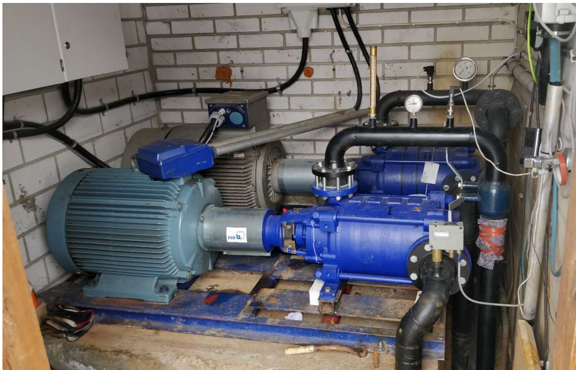
KUVA 7 Paineenkorotuspumppaamon pumput. Rantapumppaamolta tuleva vesi purkautuu pumppujen alapuolella olevaan kaivoon, josta paineenkorotuspumpput pumppaavat vettä rinteissä sijaitseville lumitykeille 26–28 baarin paineella. (Viherkoski 2021, CC BY-SA.)
