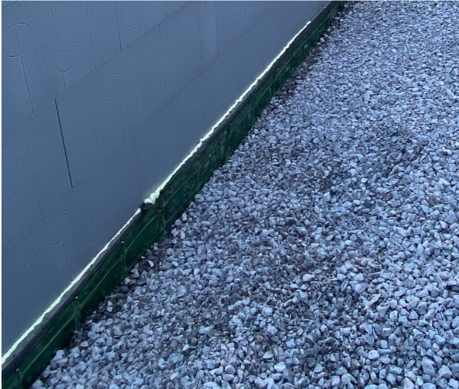
Kuva 11. Alin lämpöharkkovervi asianmukaisesti uretaanivaahdolla tiivistettynä.
