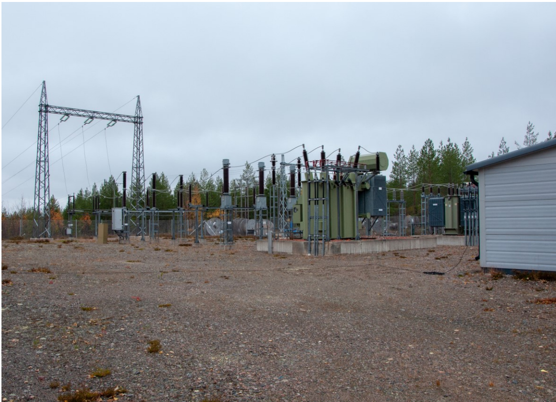
KUVA 9. Yhden päämuuntajan 110 / 20 kV muuntoasema
