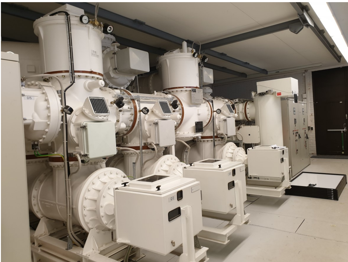
KUVA 16. Palkisentien 110 kV GIS-kojeisto
