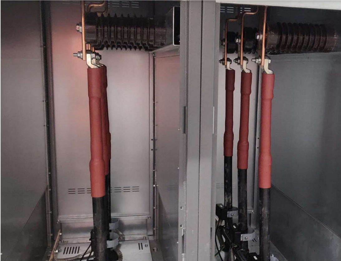
KUVA 17. AHXAMK-W 3x185AL+35CU -kaapelit liittymiskenoissa
