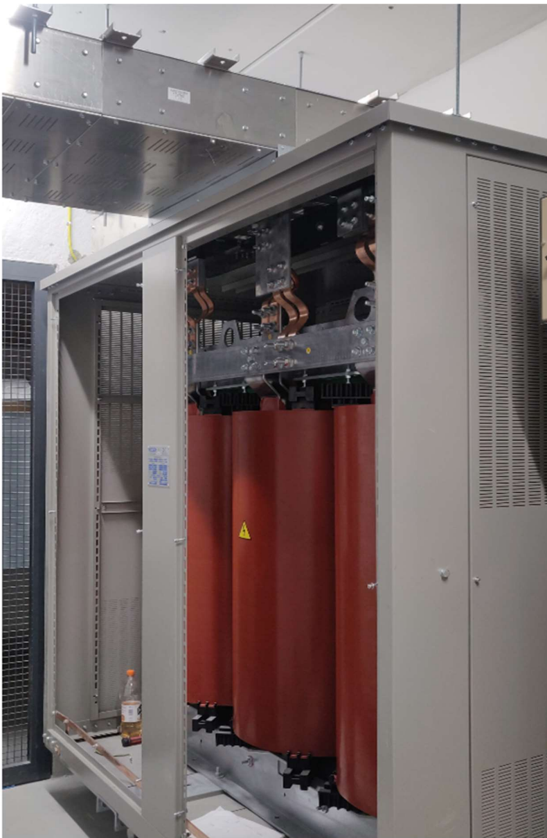
KUVA 13. Asennettu valuhartsieristeinen muuntaja suojakotelo avattuna
