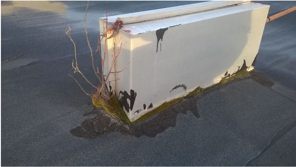
Kuva 14. Kuntoluokkaa määritettäessä läpivientien tiiveys on yksi tarkasteltavista asioista
