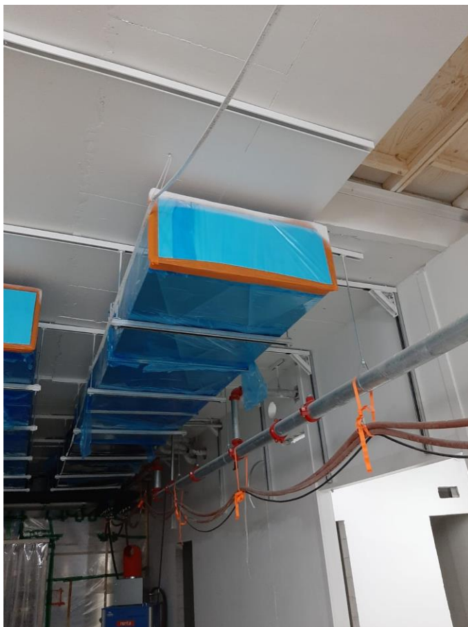
KUVA 9. Ilmanvaihtokanavan pää tulpattu
