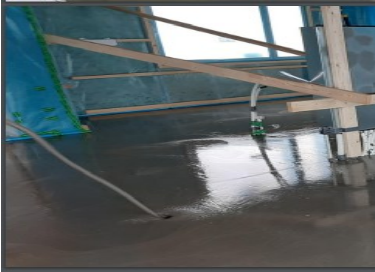
KUVA 5. Vesiputken juuressa vuotokohta
