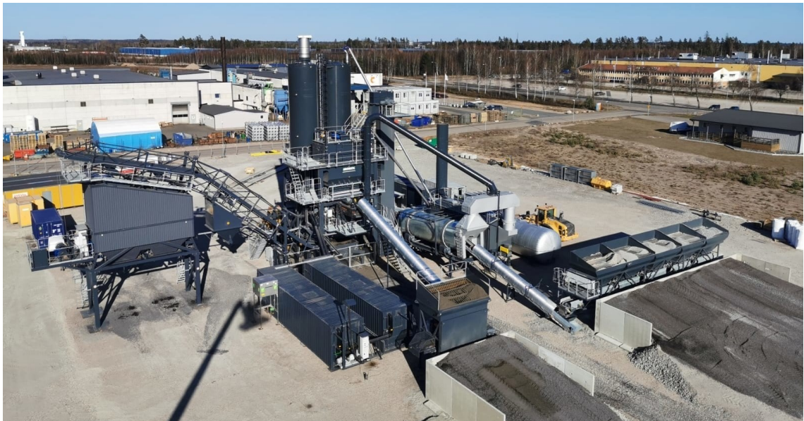
Kuva 1. Amomatic 200-240 SM asfalttiasema (Amomatic).
