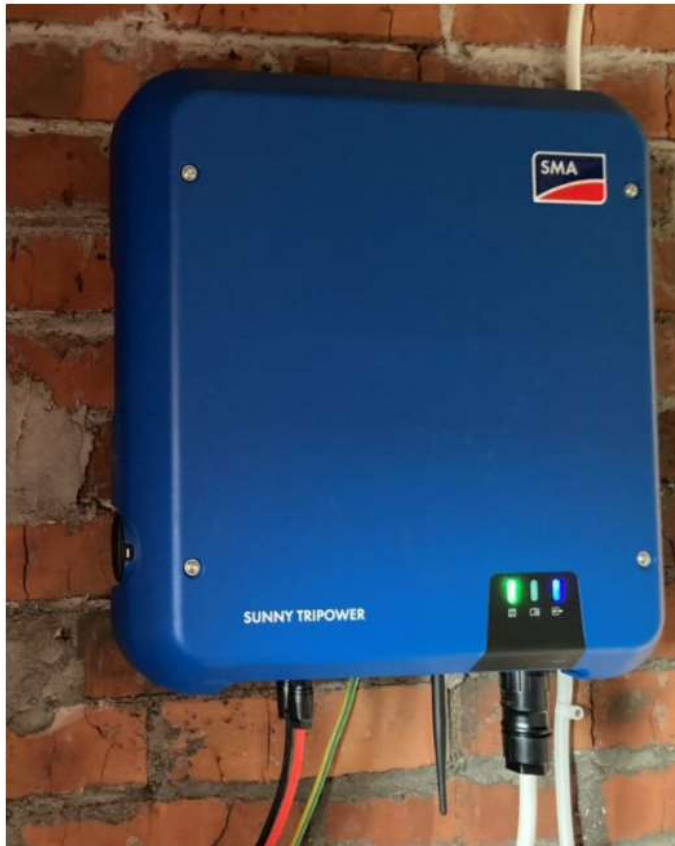
Kuvio 8. SMA Sunny Tripower 3.0 -invertteri tiiliseinälle asennettuna. (Invertteri 2021)
