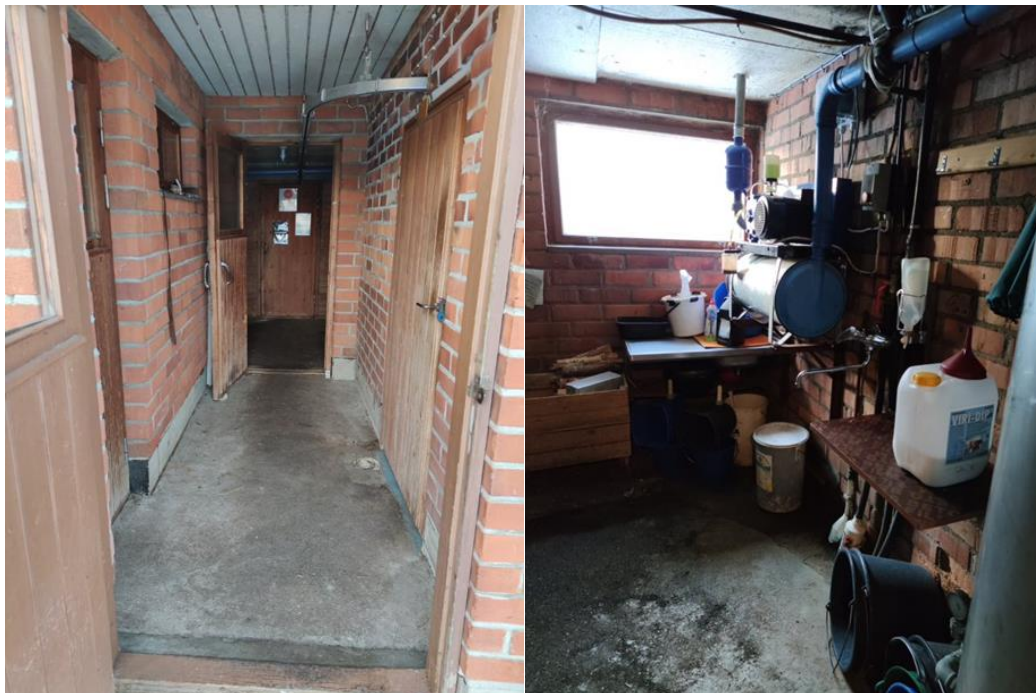
KUVA 20. Eläintilaan vievä käytävä, johon olisi tarkoitus suunnitella tautisulku. Käsienpesupiste sijaitsee karjakeittiössä. (Holappa 2021-01-09b.)
