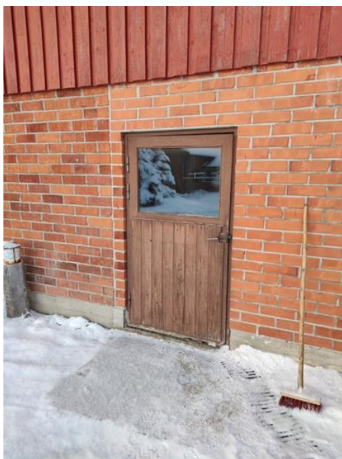
KUVA 19. Ulko-ovesta puuttuu vierailijoiden ohjeistukset (Holappa 2021-01-09a).
