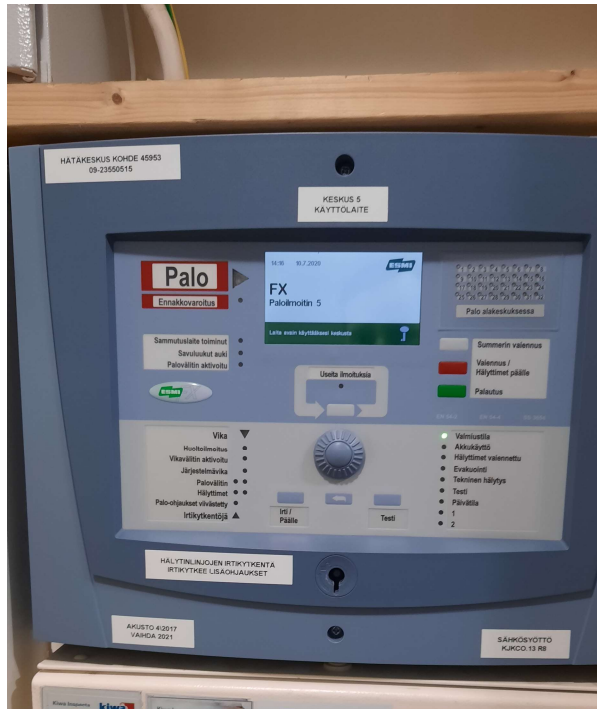
Kuva 2. Paloilmoinnin käyttölaite Urho Kekkosen kadun pääsisäänkäynnin luona, joka on myös kiinteistökokonaisuuden palokuntapaneeli.
