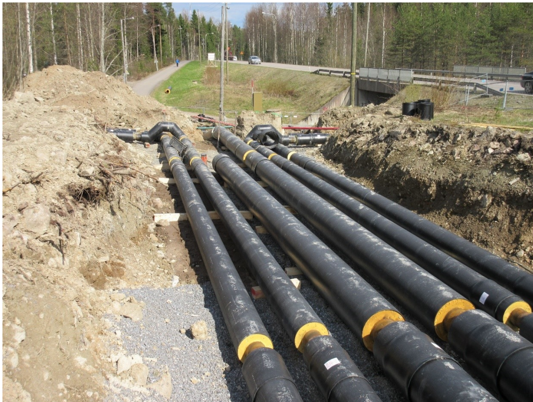
KUVA 2. 2Mpk kaukolämpörunkolinjoja (Valkonen)
