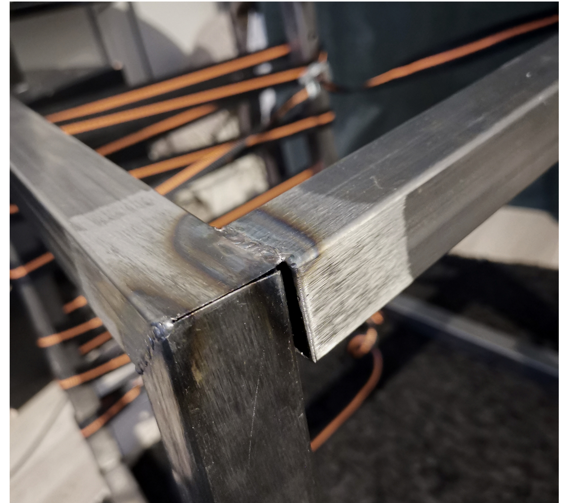
Hitsaamaton sauma rungon pohjassa antoi periksi
