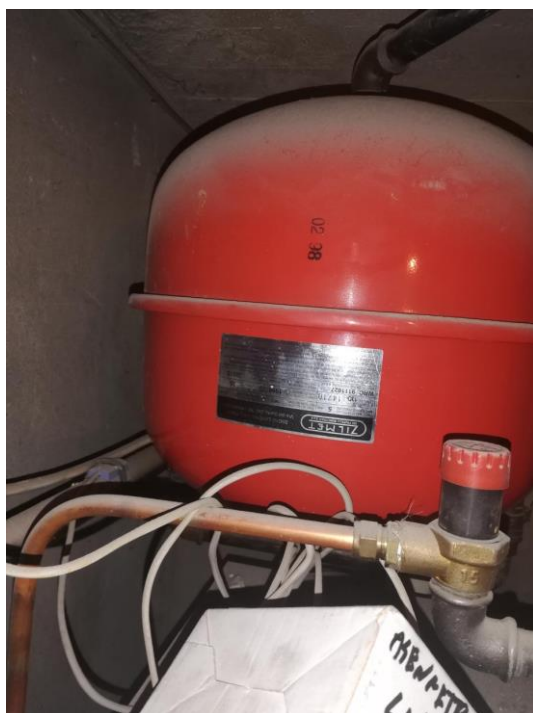
KUVA 2. Vanhan kerrostalokohteen paisunta-astia sekä varoventtiili
