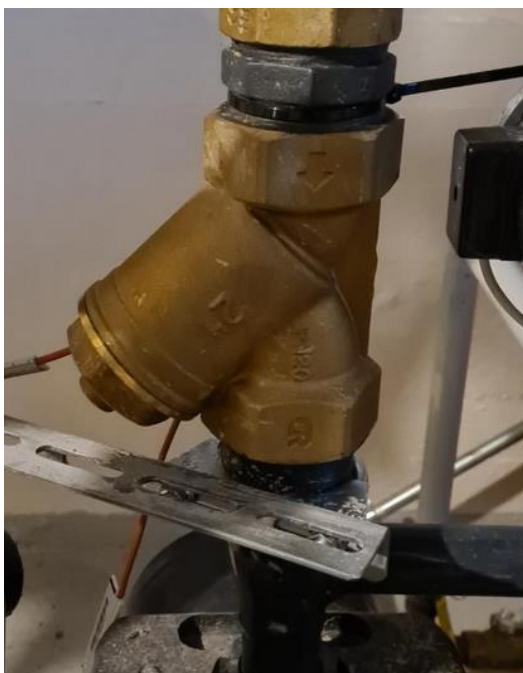
KUVA 9. Lämmönjakokeskuksen mudanerotin tutkimuskohteessa
