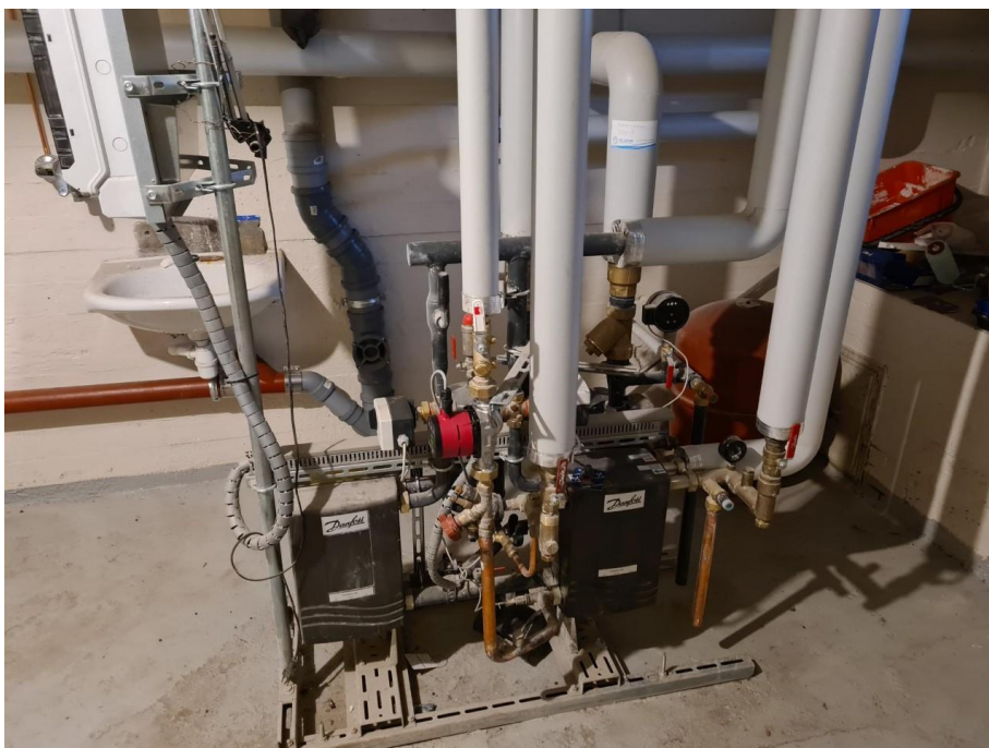
KUVA 3. Tutkimuskohteen kaukolämmön alajakokeskus
