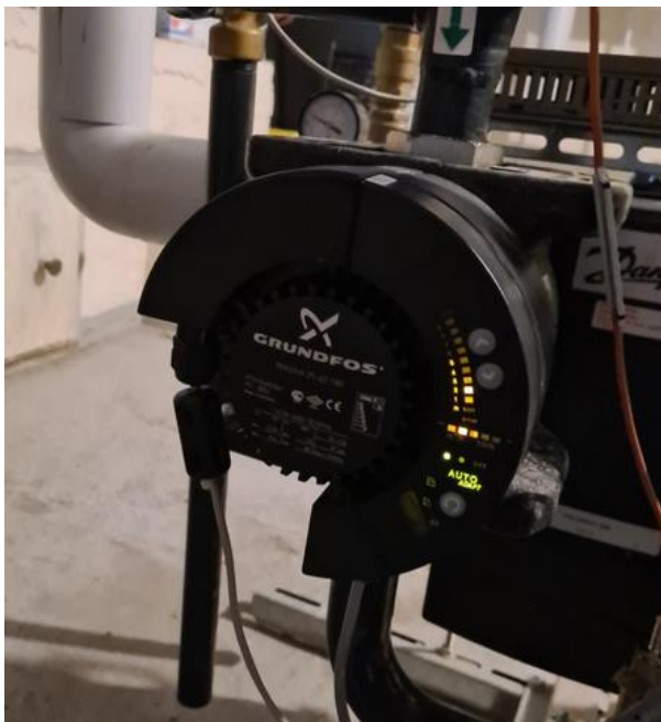
KUVA 12. Moderni taajuusmuuttajaohjattu kiertovesipumppu
