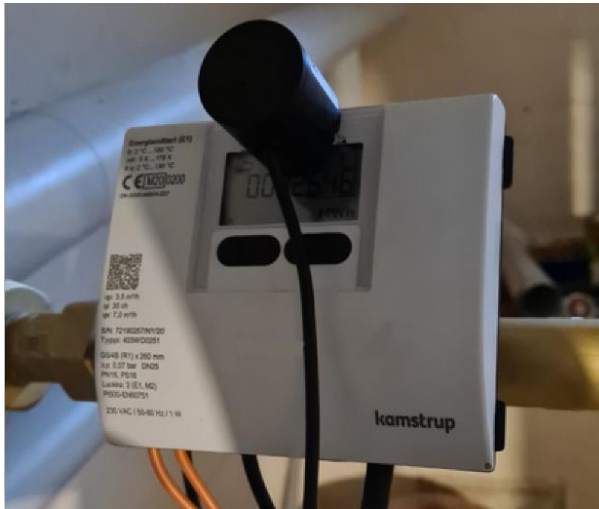
KUVA 13. Kamstrup Multical 403 -energiamittari ja optinen kaapeli
