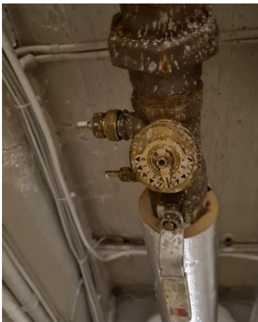
KUVA 11. Vanha linjasäätöventtiili lämmitysverkostossa
