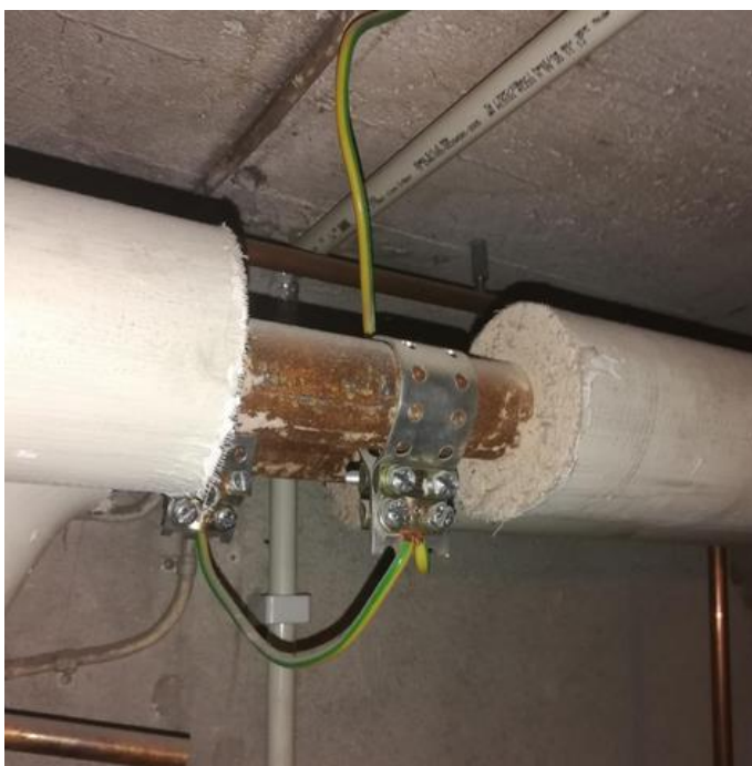
KUVA 7. Vanhan kerrostalokohteen lämmönjakoputkiston runkolinja
