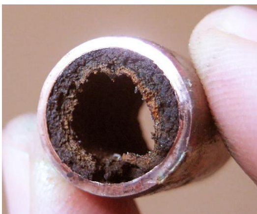
KUVA 6. Putken sisäpinnalle kertynyt sakka (Lämmönhuolto PRO Oy n.d.)
