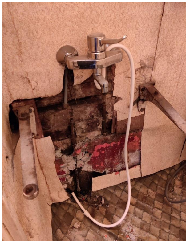
Kuva 39 Vuotaneet putket aiheuttaneet vaurioita
