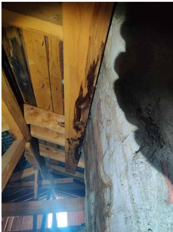
Kuva 13 Piipun läpivienti on vuotanut ja aiheuttanut vaurioita (Havukainen 2021)
