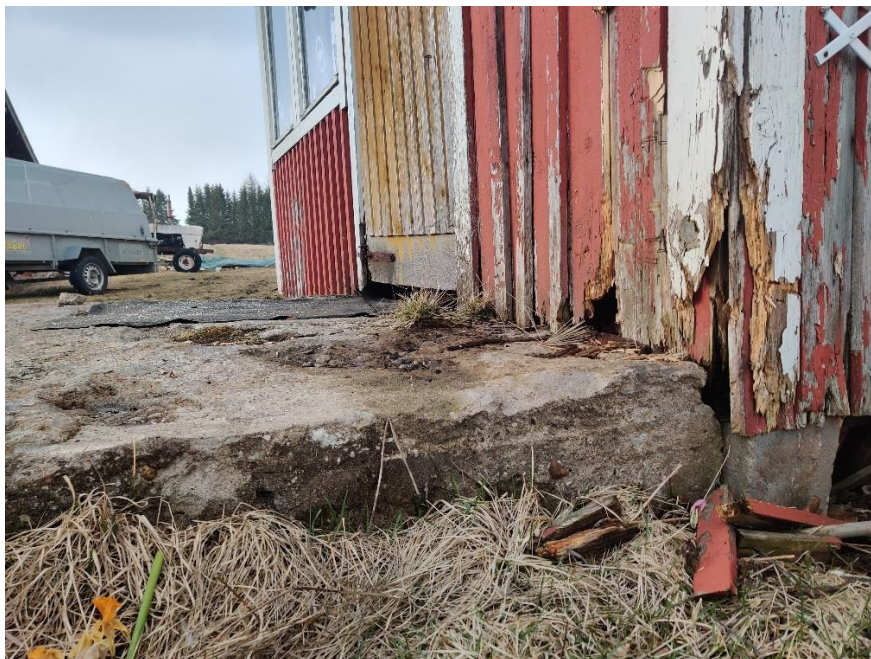
Kuva 11 Kuistin ulkoseinä on vaurioitunut portaiden kohdalta (Havukainen 2021)
