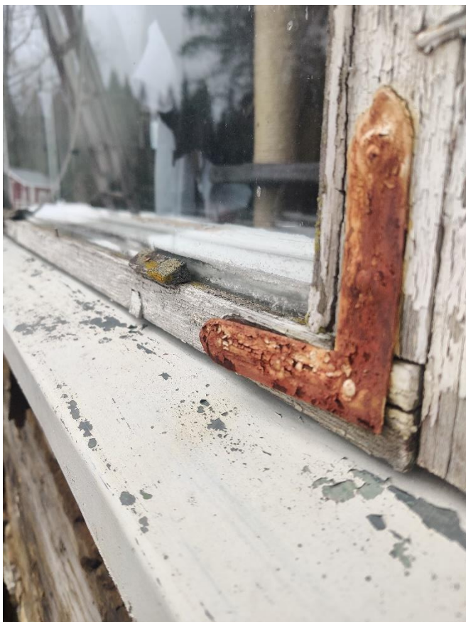
Kuva 18 Ikkunoiden alaosat vaurioituneet
