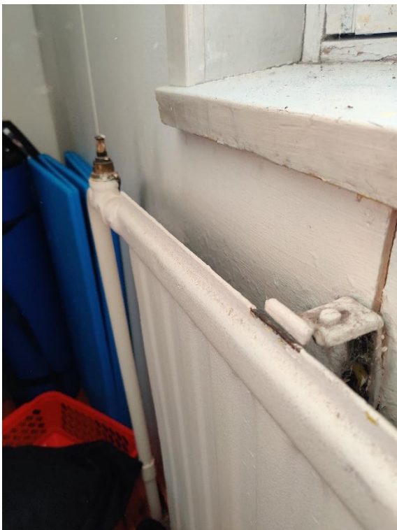
Kuva 41 Patterin säätönappi puuttuu ja kannake irti
