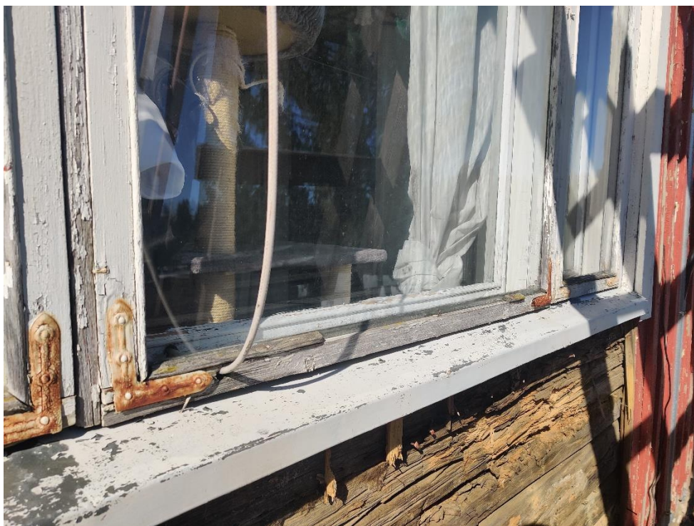
Kuva 8 Ikkunat ovat vaurioituneet säärasituksessa (Havukainen 2021)
