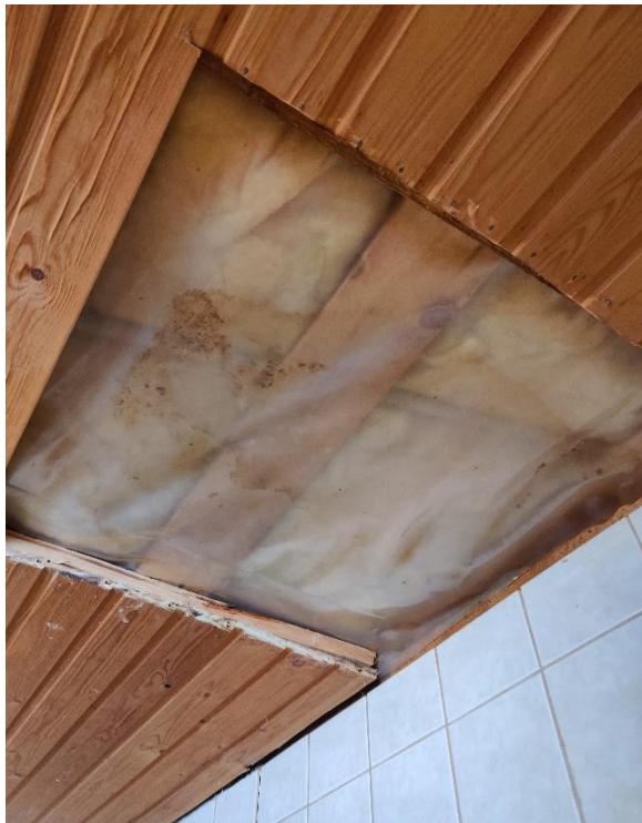
Kuva 33 Pesuhuoneen katossa jälki kosteudesta
