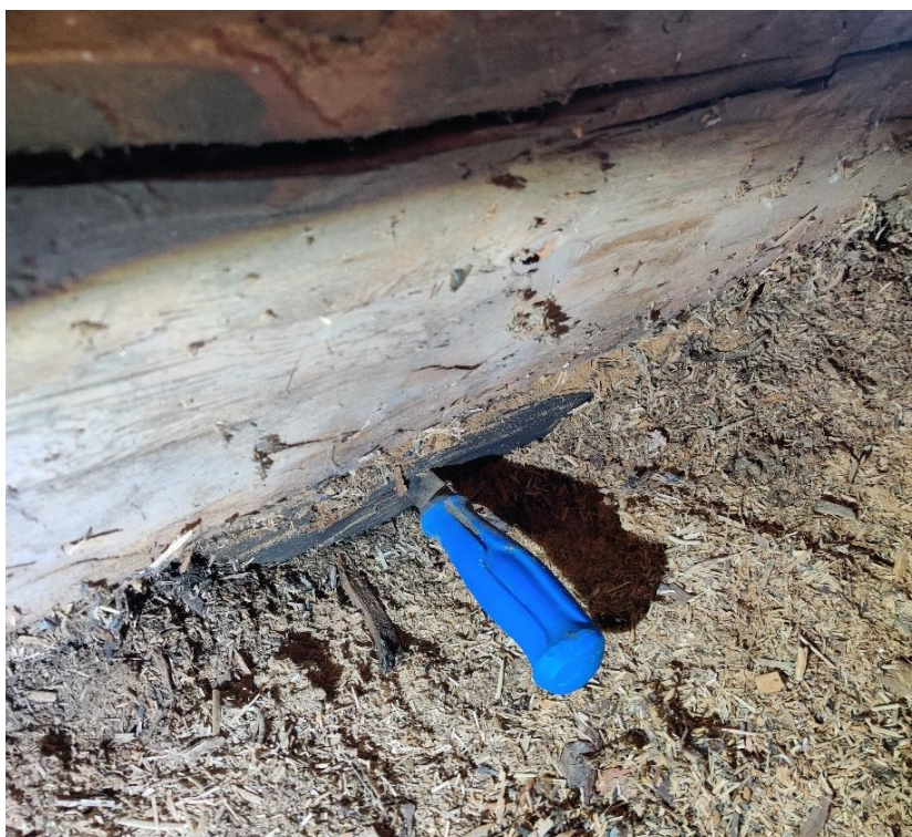
Kuva 12 Hirret ovat lahonneet yläpohjan ja seinän liitoskohdasta (Havukainen 2021)
