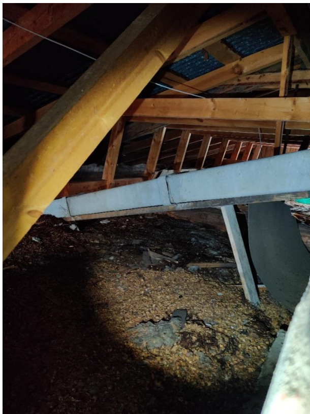
Kuva 19 Poistoilmakanavissa on asbestia (Havukainen 2021)
