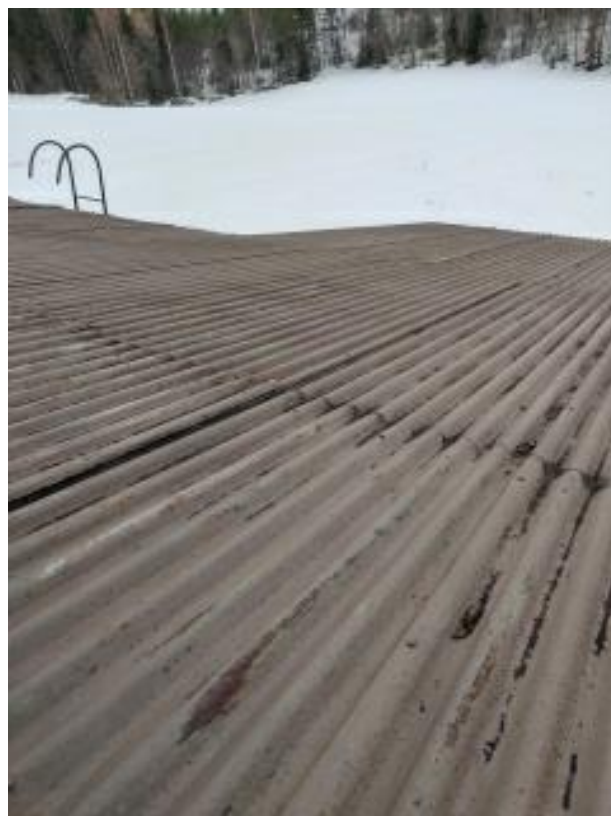
Kuva 26 Kattopelleistä pinnoite kulunut ja ruostetta paikoittain
