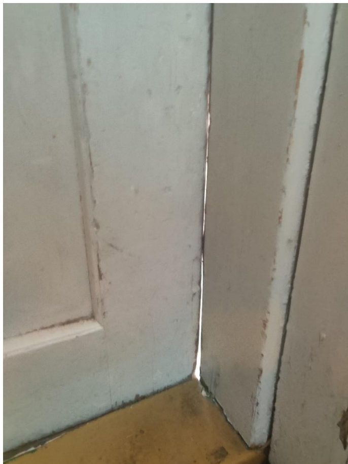
Kuva 20 Ulko-ovi epätiivis käyristymisen takia
