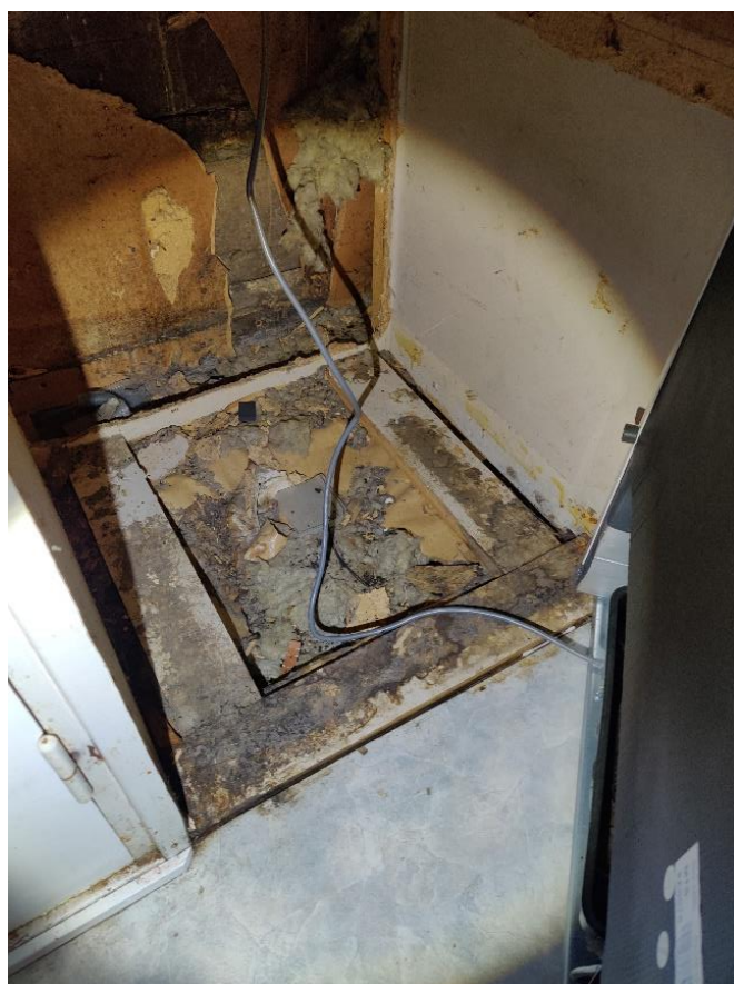
Kuva 5 Jääkaapin alla hiirten jätöksiä ja onkaloita (Havukainen 2021)
