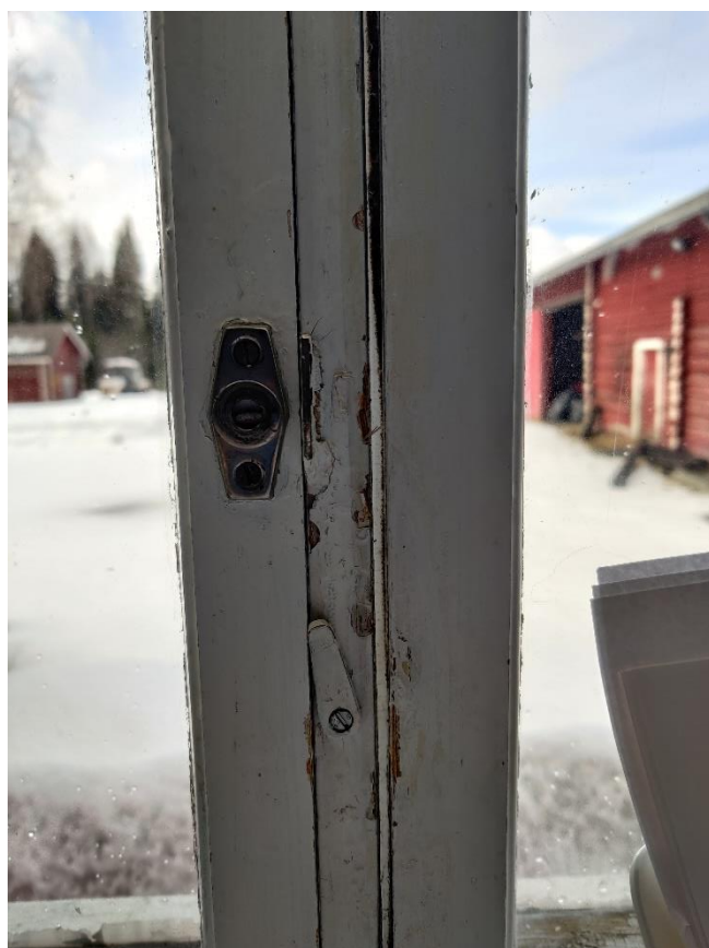
Kuva 19 Ikkunoiden sisälasit epätiivit
