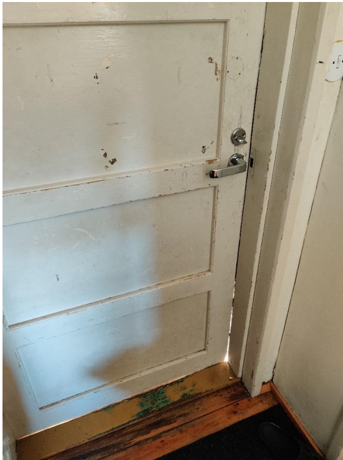
Kuva 9 Ulko-ovi ei ole tiivis (Havukainen 2021)
