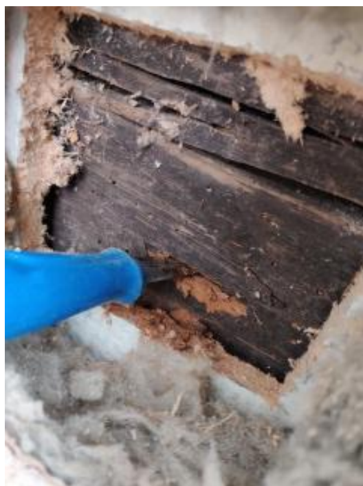
Kuva 14 Hirren sisäpinta vaurioitunut olohuoneen kohdalta
