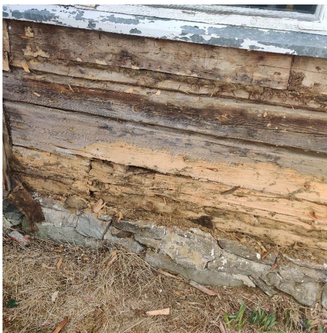
Kuva 12 Etupihan ulkoseinän alaosa vaurioitunut
