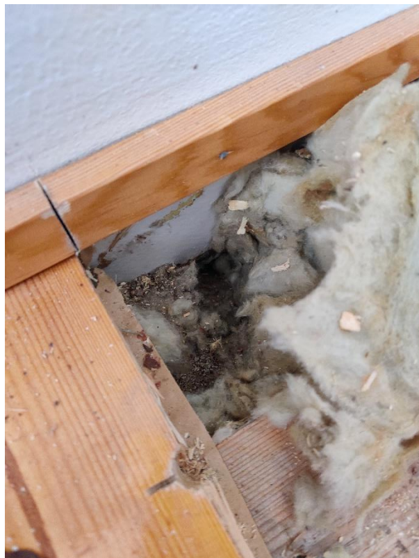
Kuva 9 Olohuoneessa seinän vieressä lattiassa hiirten onkaloita
