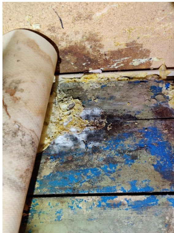
Kuva 44 Viemäriputken vuoto aiheuttanut homekasvustoa
