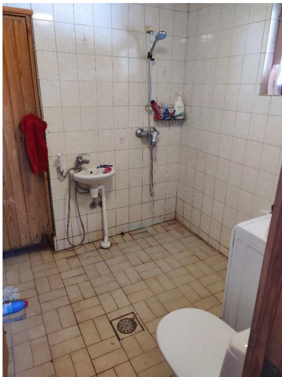
Kuva 14 Pesuhuoneen pintarakenteet ovat huonossa kunnossa (Havukainen 2021)
