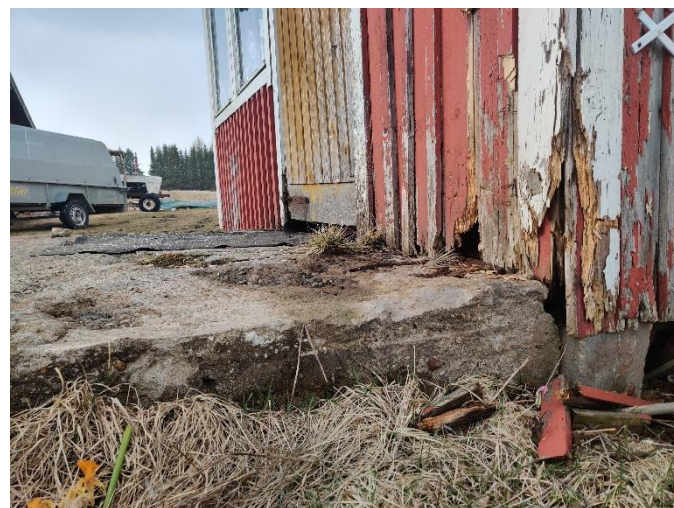
Kuva 24 Kuistin verhous lahonnut
