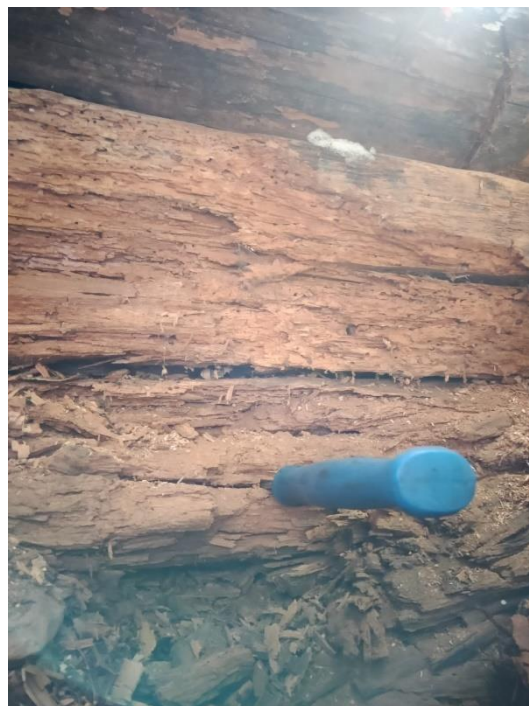
Kuva 28 Ulkoseinän hirret pahoin lahonneet yläpohjan ja seinän liittymässä
