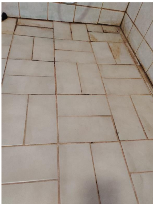
Kuva 31 Laatoitus huonossa kunnossa
