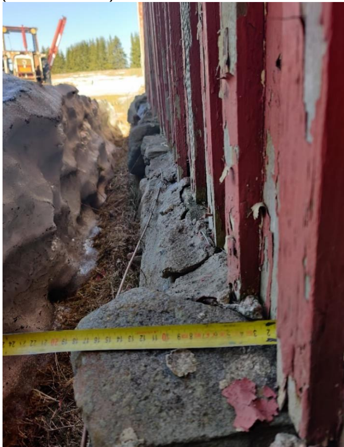
Kuva 2 Sokkeli monin paikoin ulkoneva (Havukainen 2021)
