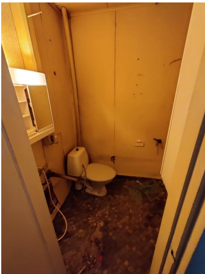
Kuva 37 Wc ollut poissa käytössä noin 20-vuotta
