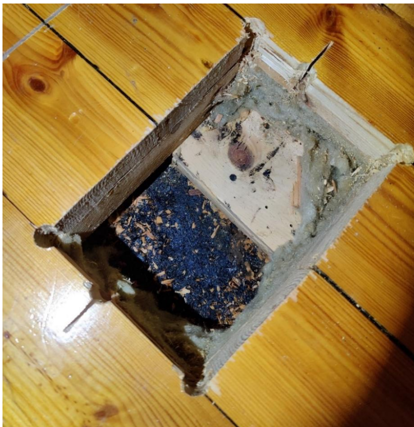
Kuva 4 Alapohjarakenteen kunto oletettua parempi (Havukainen 2021)
