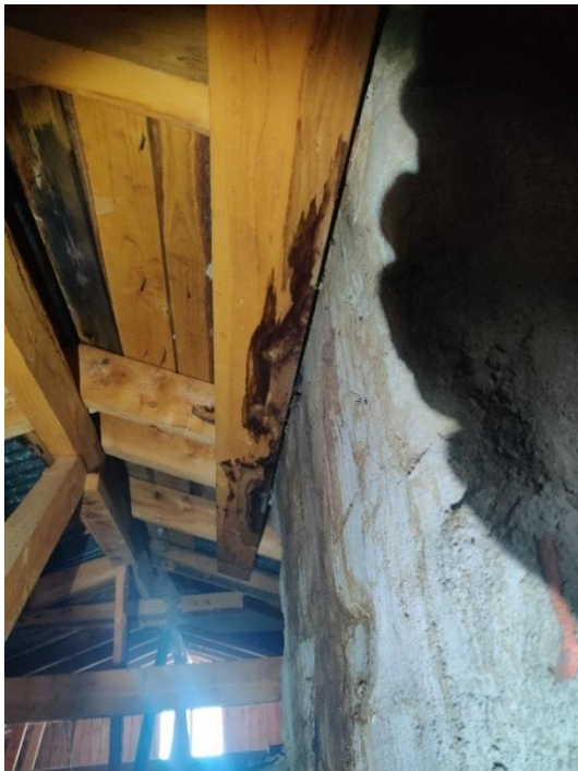
Kuva 27 Piipun läpivienti vuotanut ja aiheuttanut vaurioita
