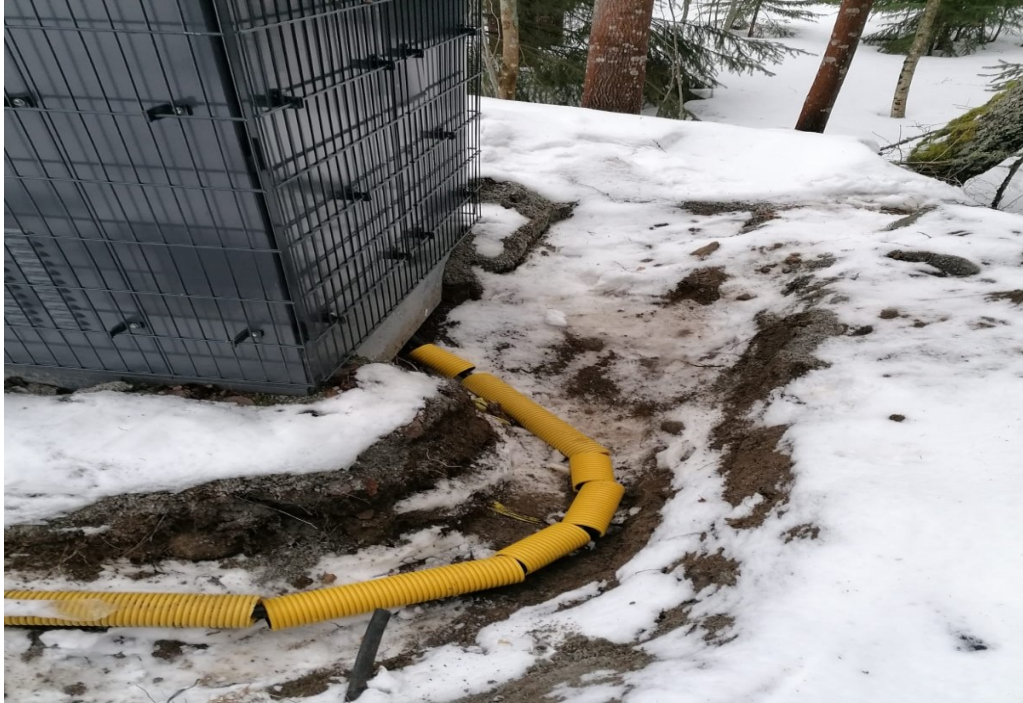
KUVA 11. PJ-kaapeli tuotu puistomuuntamon sisään (Tikkanen, 2021).
