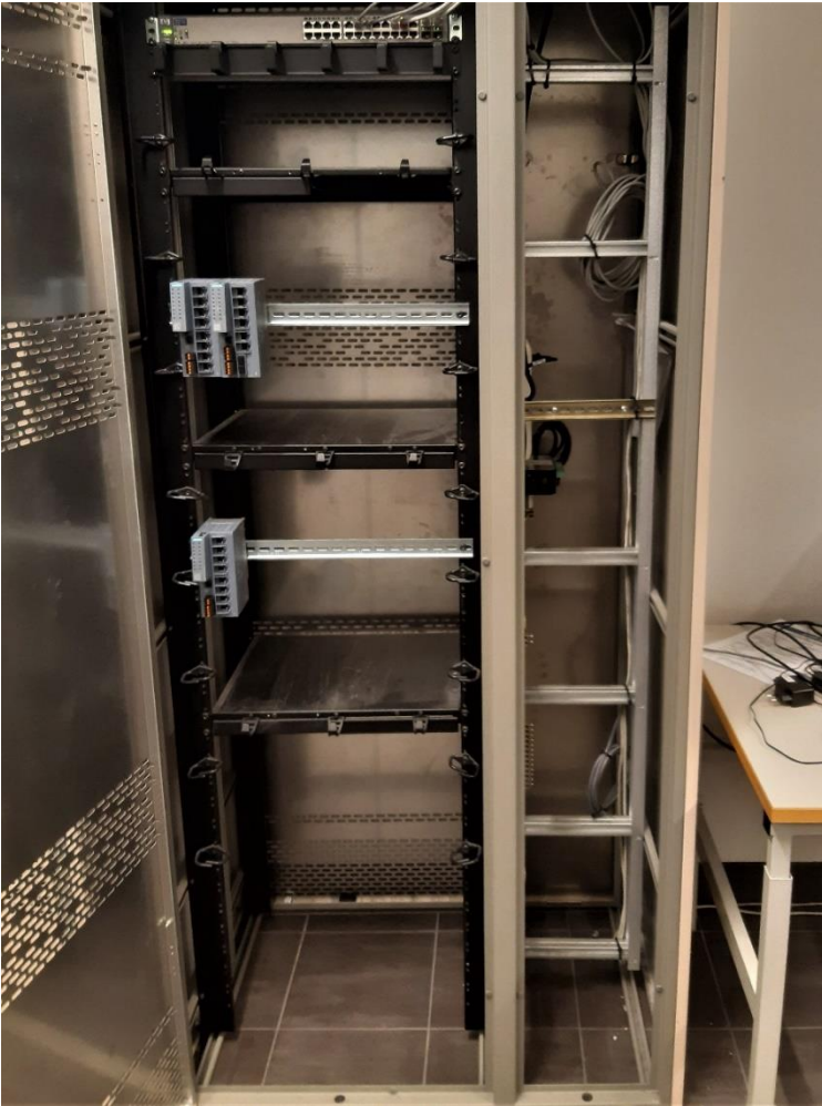
Kuvio 25. Verkkolaiteräkki valmiina kaapelointiin
