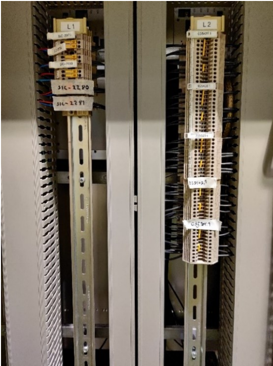
Kuvio 12. Alcont-keskuskaapin ristikytkentätilassa olevat riviliittimet
