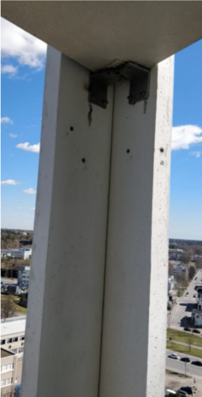
Kuva 18 Kuvassa näkyy, että kiinnikkeet ovat olleet liian lähellä toisiaan. Tämä on johtanut siihen, että pielelementit on jouduttu kiinnittämään teräsprofilein parvekelaattaan.
