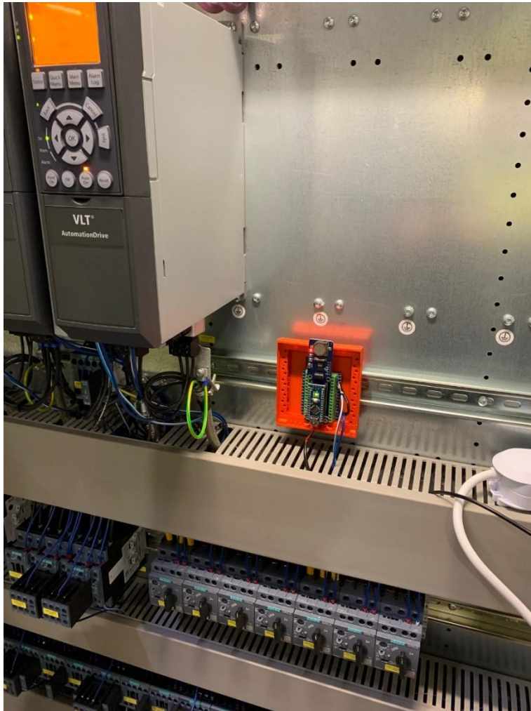
Kuva 8. Taajuusmuuttaja ja tiedokeruulaitteisto (P.Mikkonen 2021)
