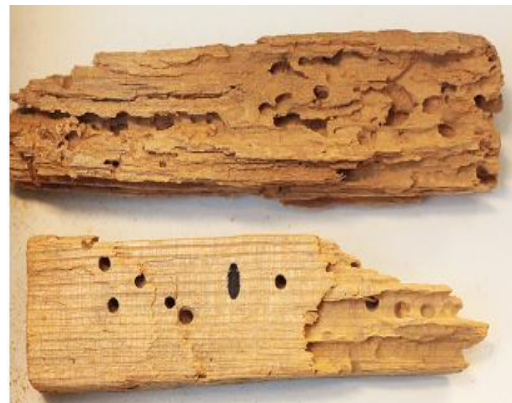
Kuva 10 Kuolemankellon aiheuttamat vauriot [5, s. 7]
