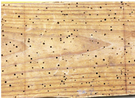
Kuva 9 Tupajumin aiheuttava vaurio [5, s. 4]
