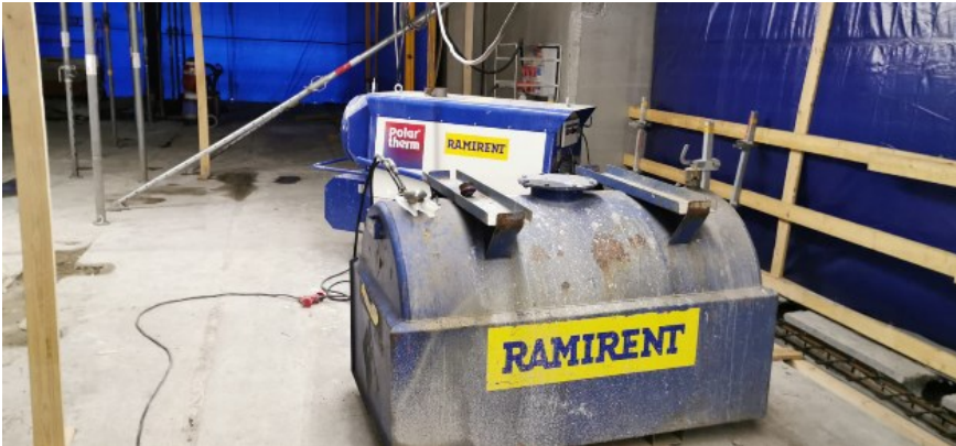
Kuva 14. Ontelokentän alapuolinen osastointi ja väliaikainen öljylämmitys.
