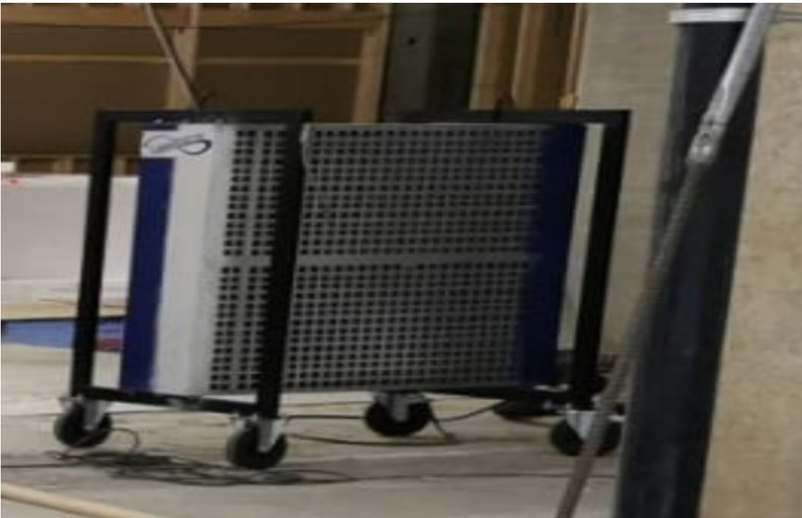
Kuva 21. Vesikiertoinen 250 kW lämpöpuhallin.
