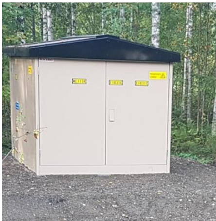
Kuva 9. Puistomuuntamo (Kuva: PKS Sähkösiirto Oy 2020).
