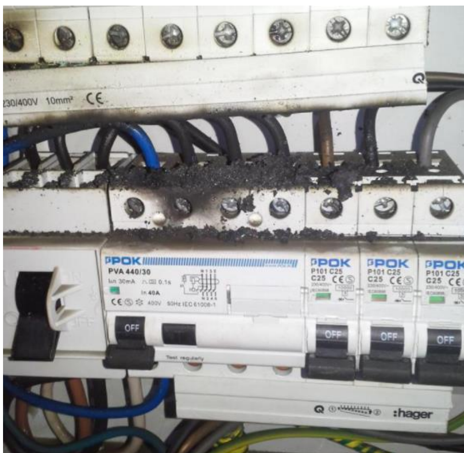
Kuva 5. Liitosta ei ole kiristetty tarpeeksi /11/
