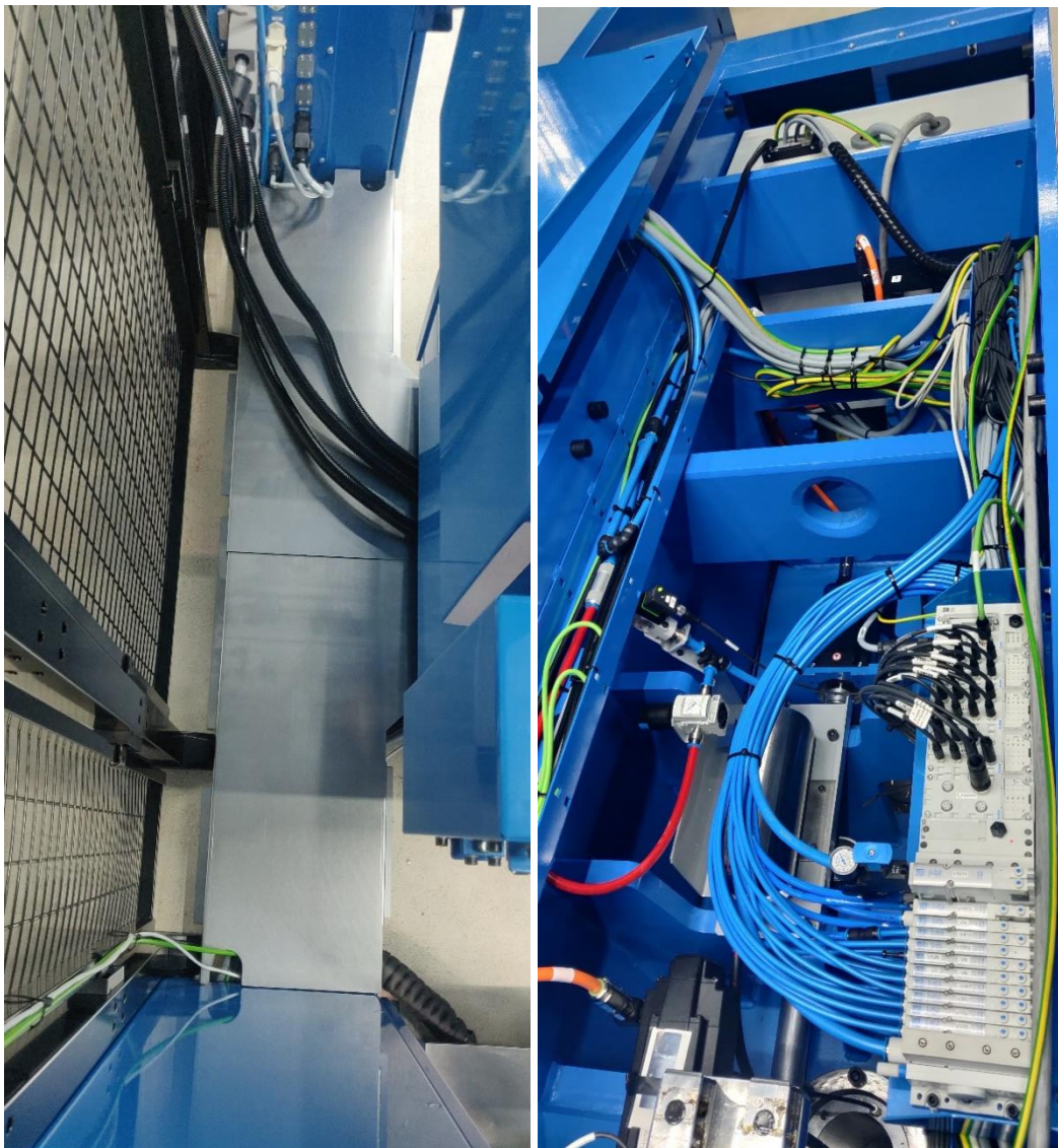
Kuva 13. Kaapelikouru sekä ylärunon kaapelireitti.
