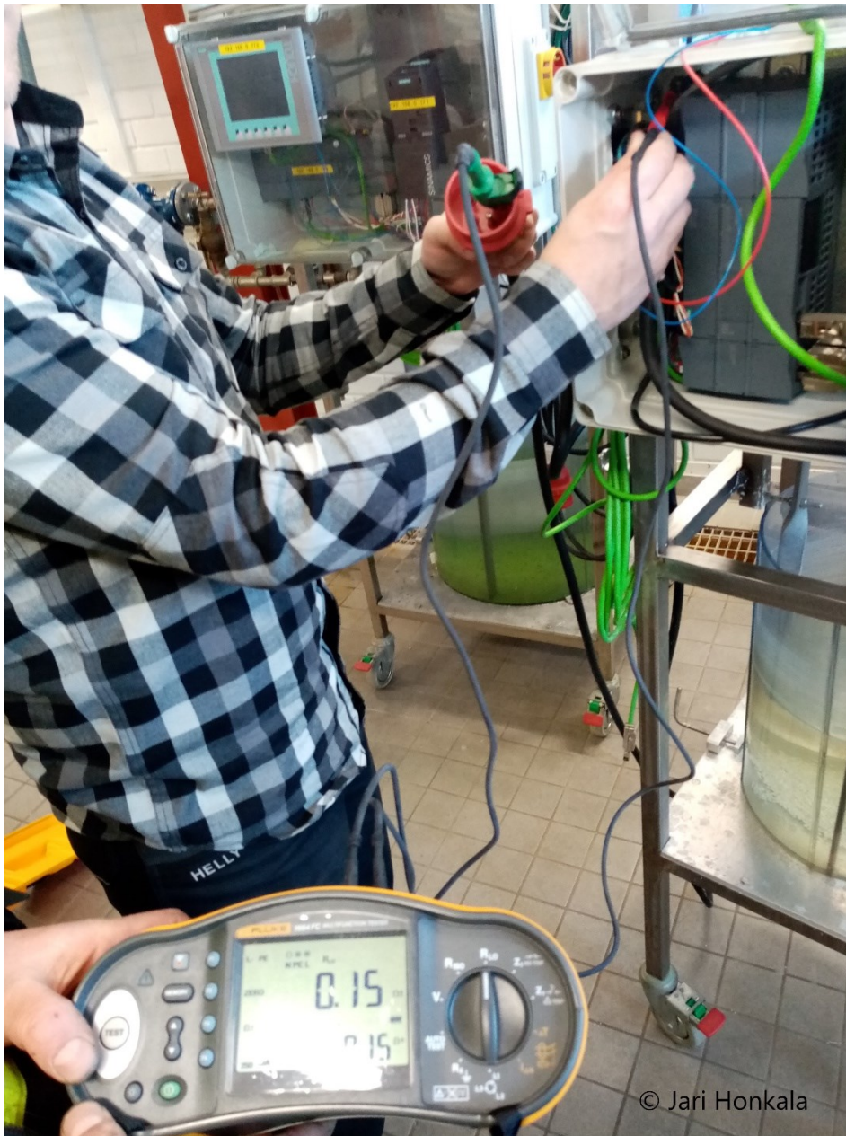
KUVA 3. Suojamaadoituspiirin mittausta pistotulpan ja laitteen suojamaadoitusliittimen väliltä
