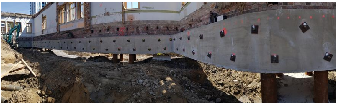
Kuva 34. Rakennus on väliaikaisten tukipisteiden varassa.
