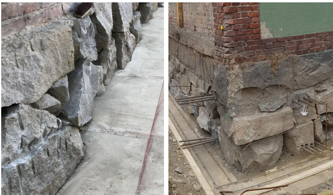
Kuva 20. ja 21. Kivilatamusosan pohjamuotti asennettuna vasemmalla, ja oikealla sokkelipalkin pääteräkset lävistävät kivilatamusosan perustusrakenteen.
