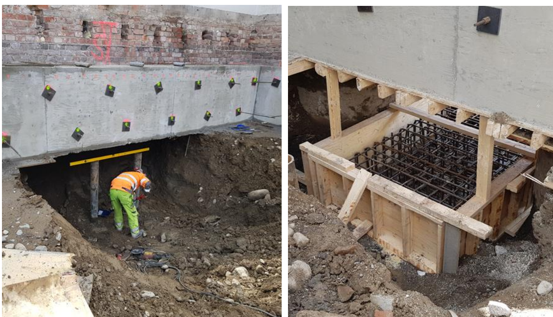
Kuvat 31. ja 32. Vasemmalla nostopisteen kaivuutyö on käynnissä sekä oikealla nostopisteen muotti raudoitettuna teräselementillä.
