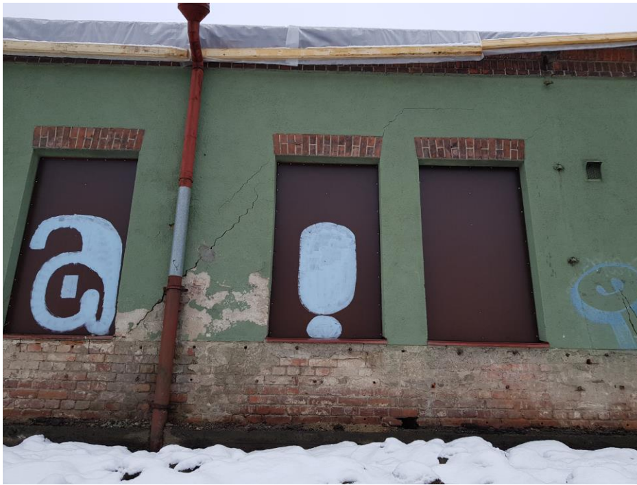
Kuva 10. Seinän halkeama aukon kohdalla.
