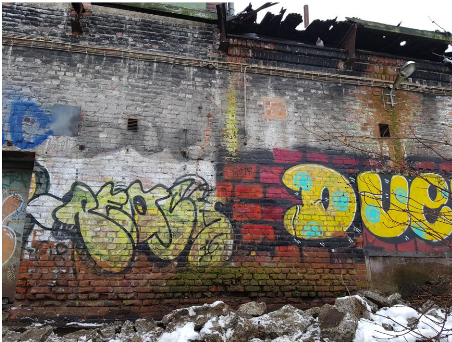
Kuva 11. Seinien tiilien laasti oli rapautunut kokonaan pois alaosistaan.
