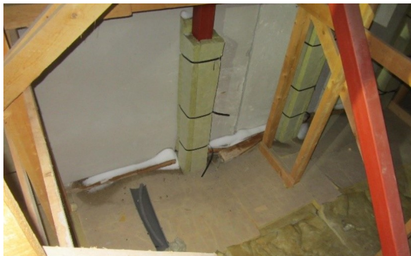
Kuva 2. Lumen haitallinen tunkeutuminen yläpohjaan (FISE)
