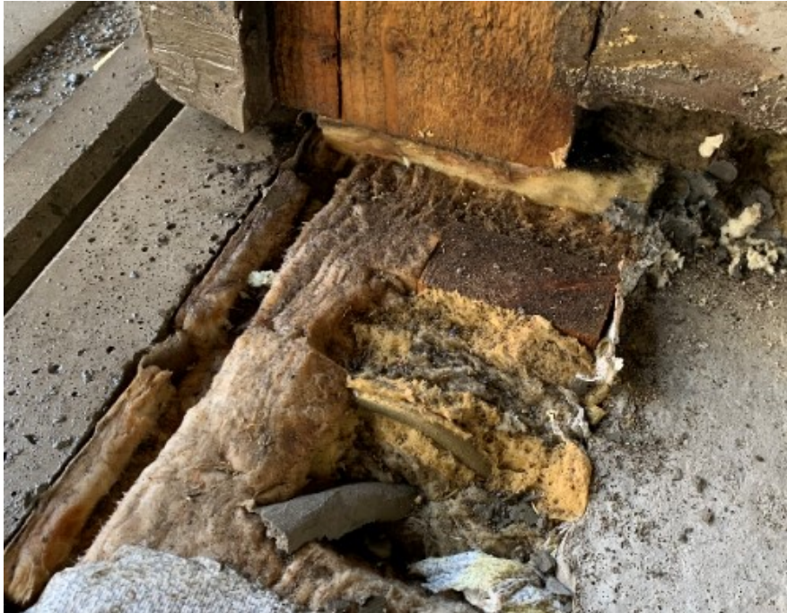
Kuva 6. Sandwich -betonielementin kastunut villatila ja apukarmit
