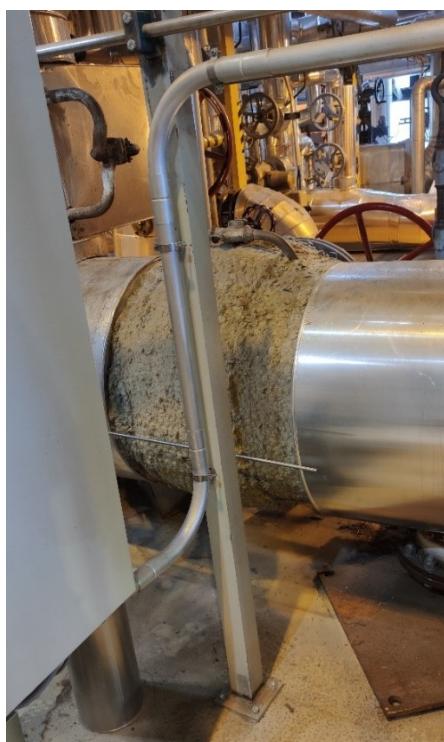
KUVA 13. Eristetty matalapainehöyrylinjan sulkuventtiili (Lohikainen 2021).
