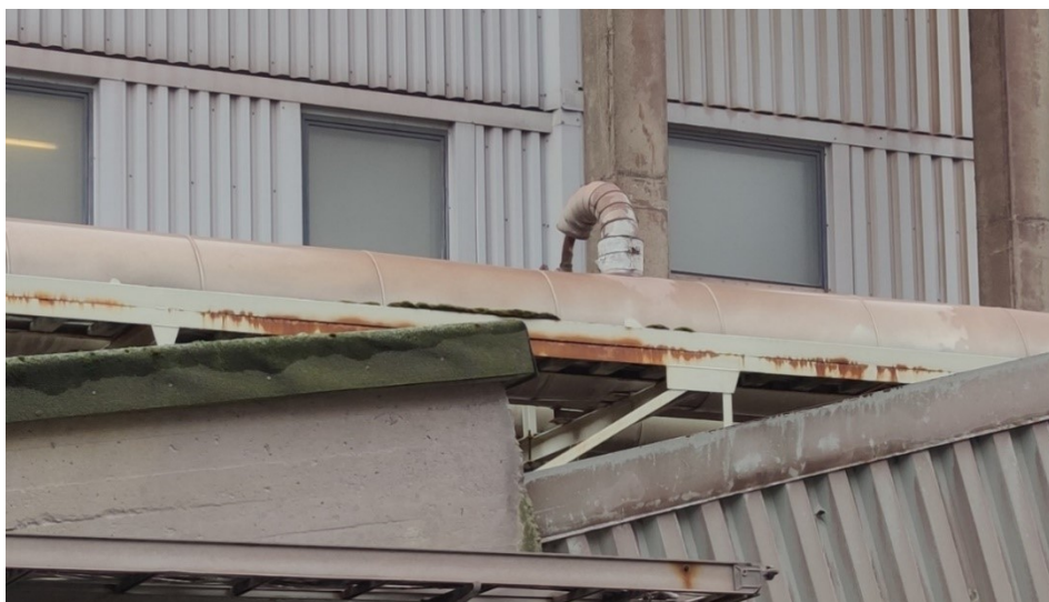
KUVA 11. Putkisillalla kulkeva matalapainehöyrylinja (Lohikainen 2021).
