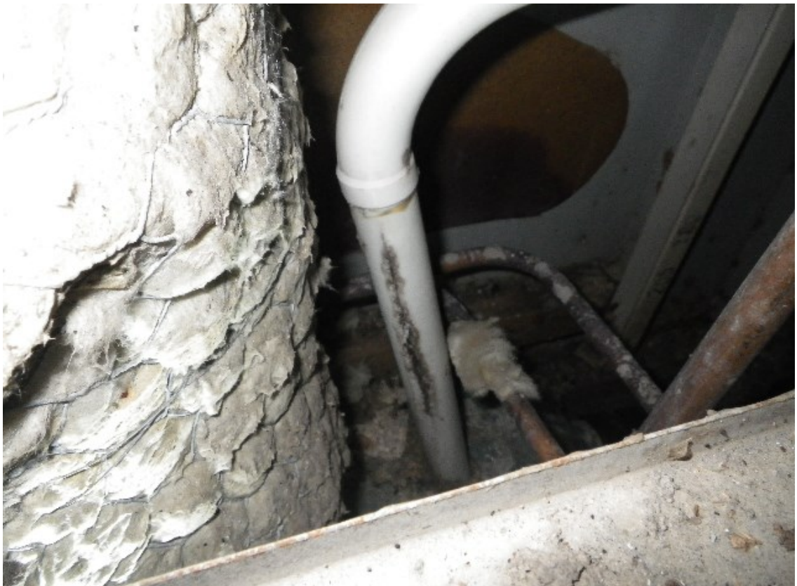
Kuva 18. Seinäkaivon päälle kytketyn pesualtaan viemäriputkessa halkeama.
