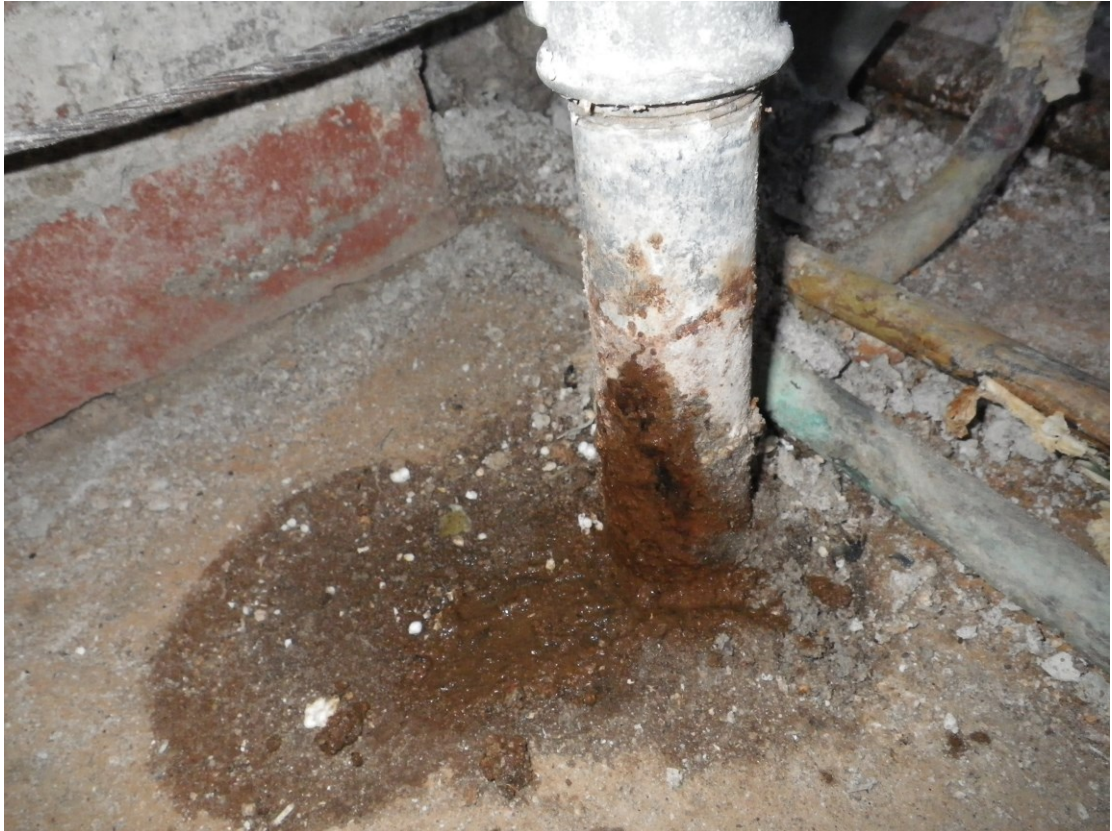
Kuva 11. Syöpymä galvanoidussa vesijohdossa
