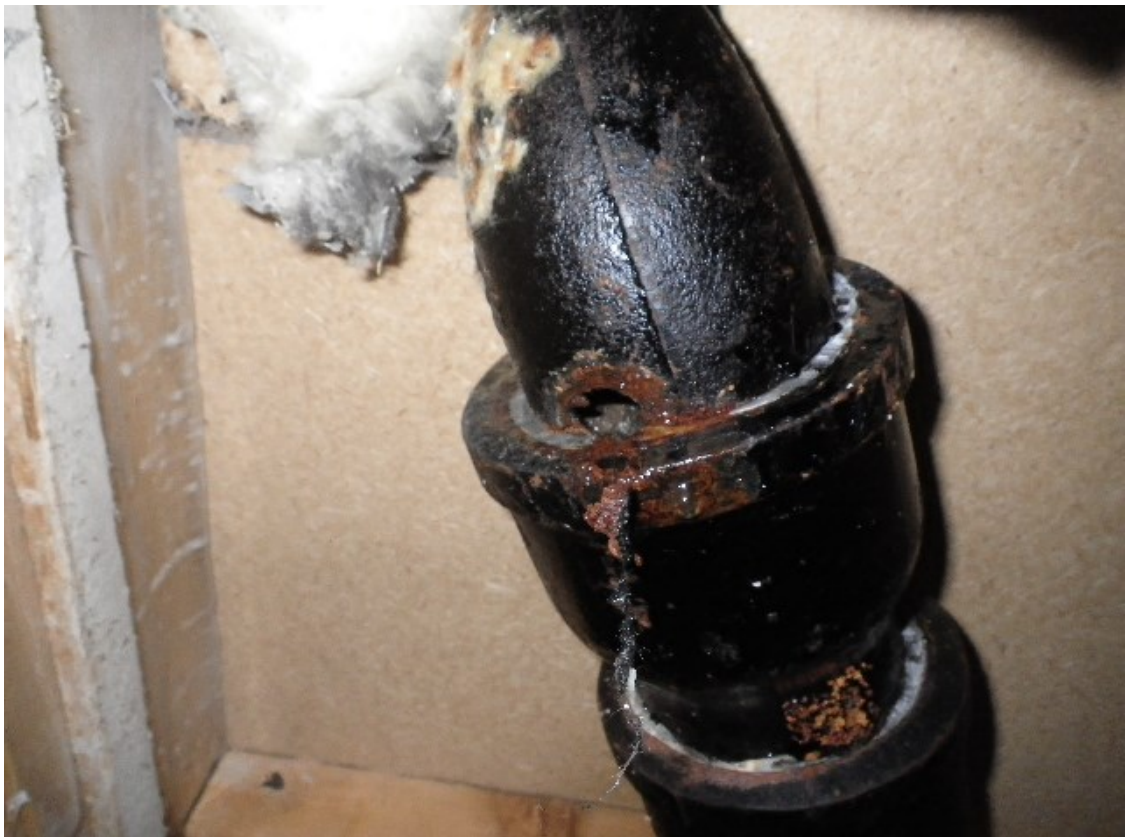
Kuva 17. 60-luvun rivitalon keittiön valurautaviemäri, joka on syöpynyt puhki ensimmäisestä mutkasta.
