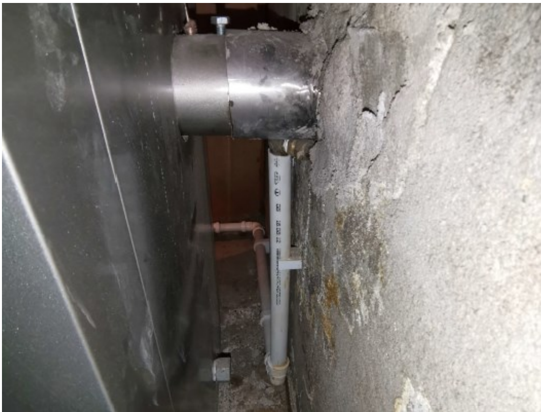
Kuva 27. Kondenssiveden poistoputki maakaasukattilan savuhormista.
