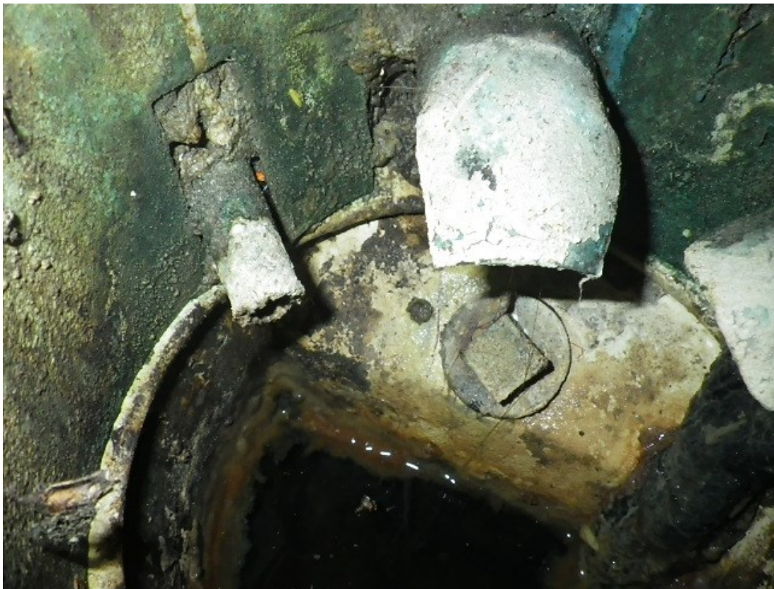
Kuva 19. Lattiakaivossa kuparinen korokerengas, jonka läpi tulee paikalleen muuratun ammeen poistoputki sekä kaukalon ylivuotoputki.
