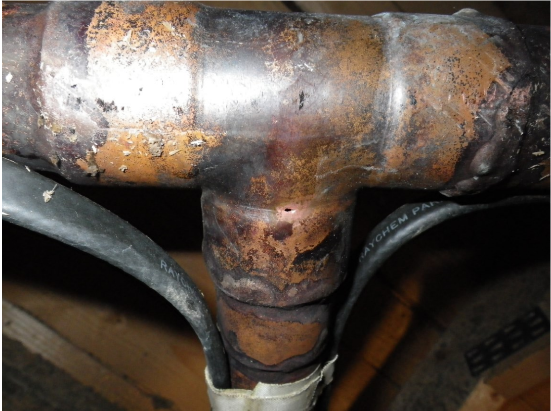
Kuva 20. Pistemäinen syöpymä kuparisessa sadevesiviemärissä.
