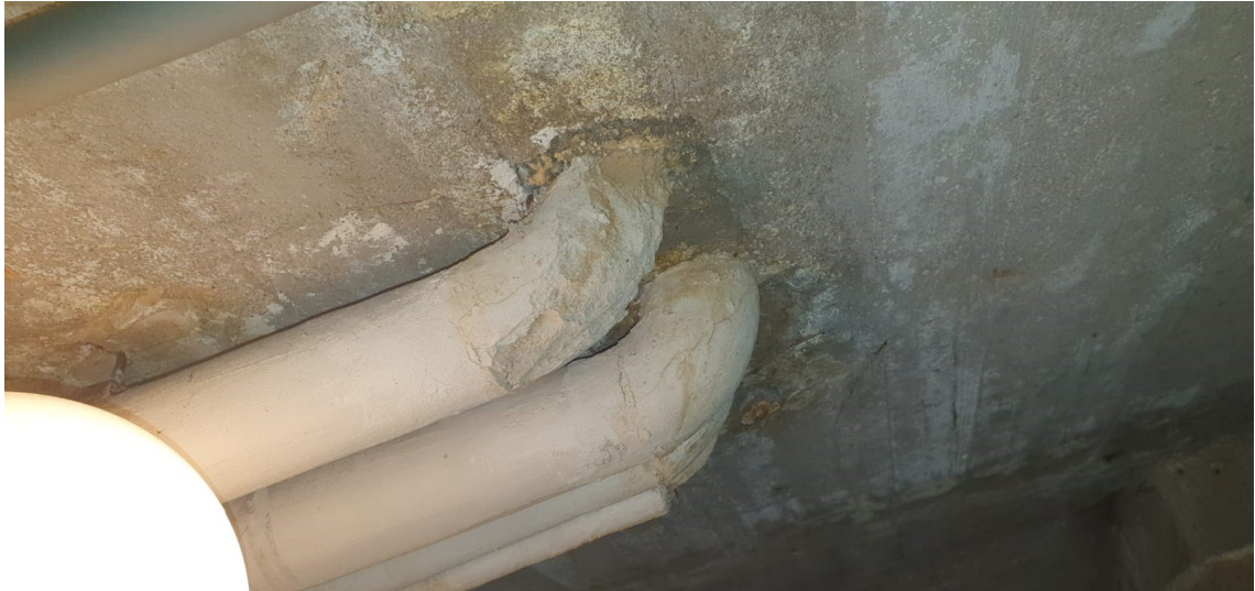
Kuva 8. Asbestimassalla eristetty lämpöjohto omakotitalon kellarikerroksessa.
