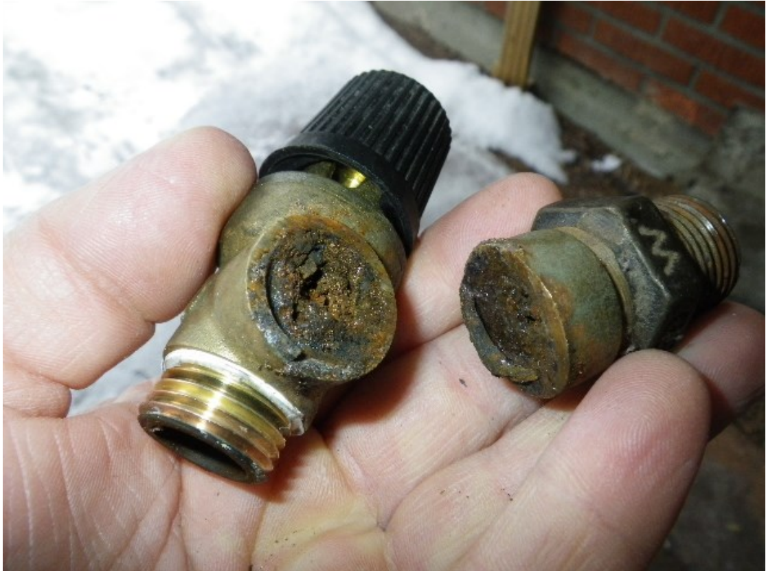
Kuva 23. Lämpimän käyttöveden varoventtiili, jonka ulospuhallusputki oli liitetty mustalla osalla.
