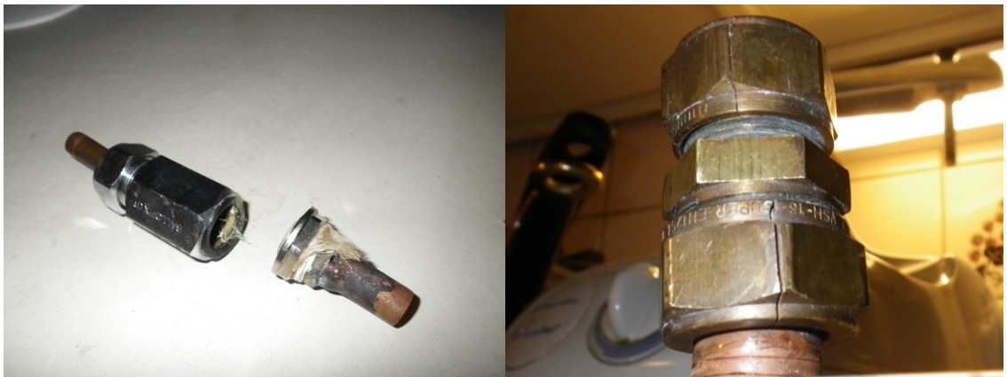
Kuva 13. Ballofix™ jolla liitetään vesijohto sekoittajaan, runko revennyt kierteen kohdalta, puserrusliitin, jossa puserrusmutteri haljennut
