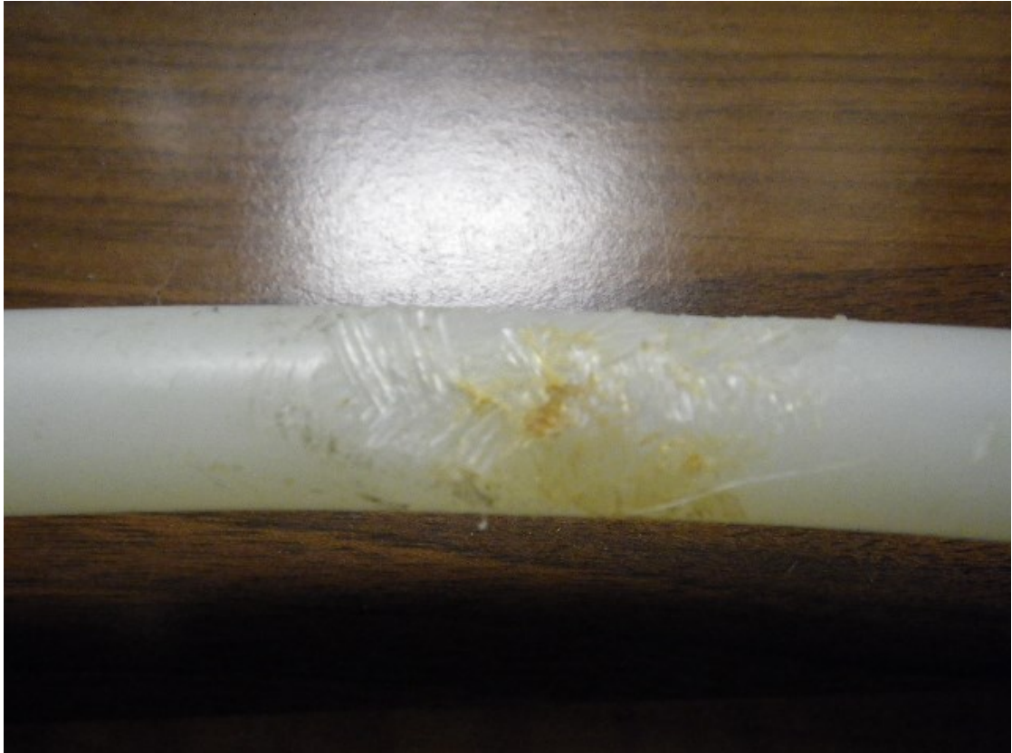
Kuva 15. Jysijän puhki syömä muovinen vesijohto
