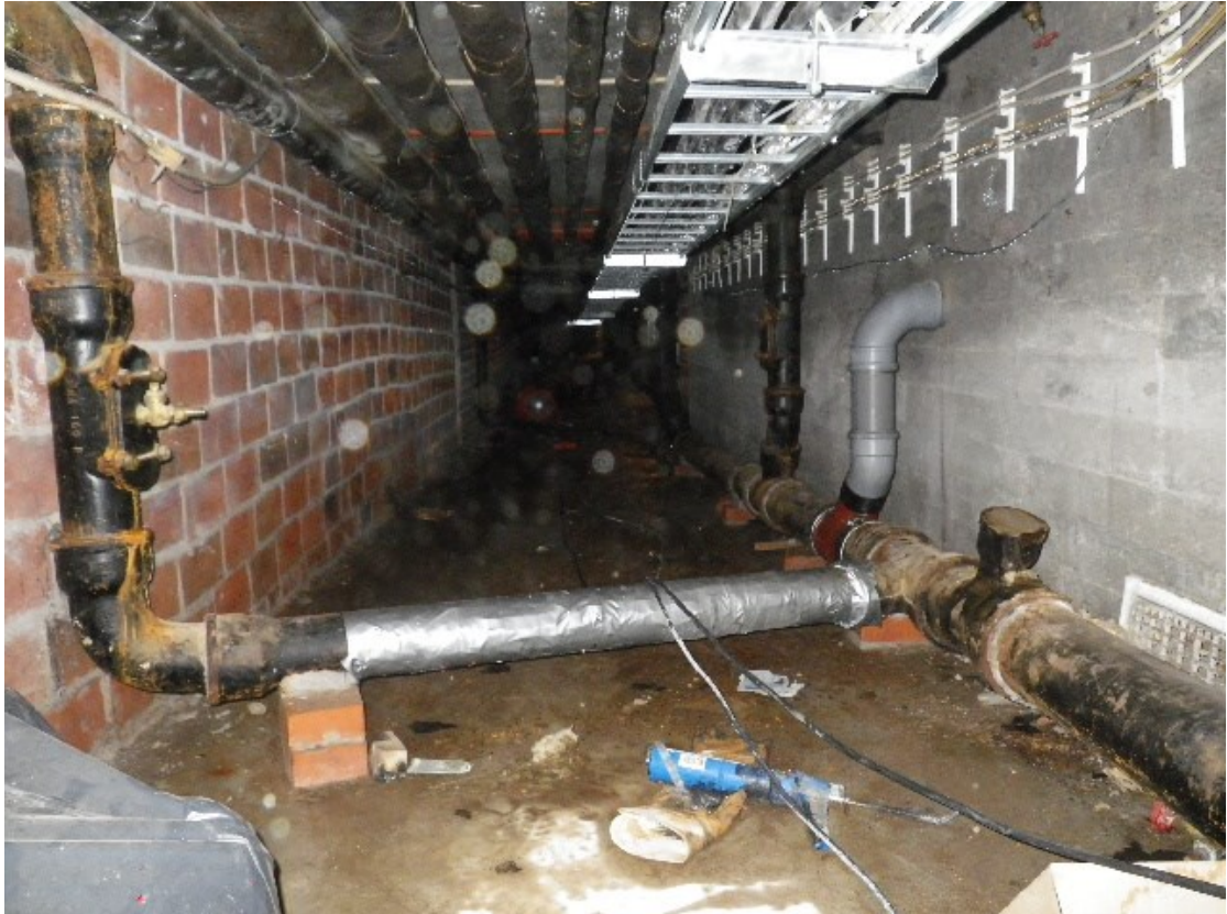
Kuva 7. Tekniikkatunneli vuonna 1957 rakennetun koulurakennuksen kellarikerroksen lattian alla.
