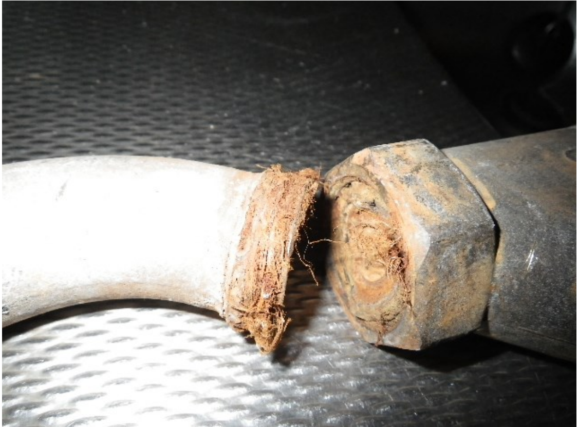
Kuva 10. Galvanoitu putken osa syöpynyt kierteen kohdalta
