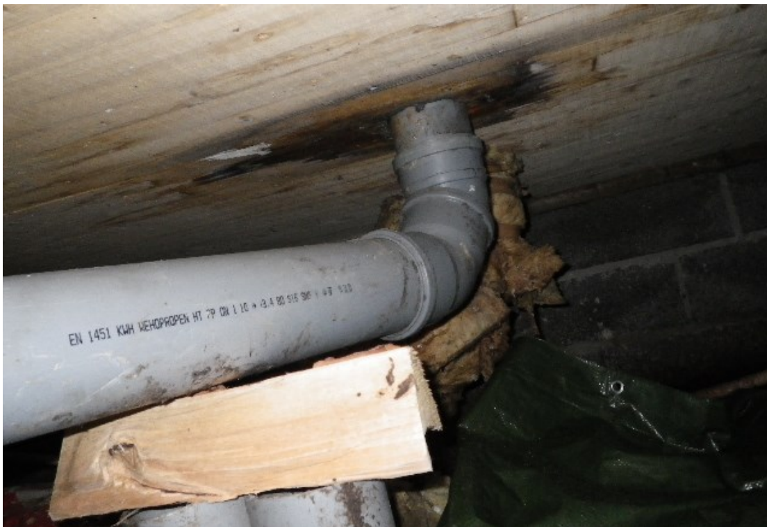
Kuva 24. Puutteellinen kannakointi 2000 -luvun omakotitalon alapohjan ryömintätallassa, viemäriputki oli irronnut liitoksestaan, ryömintätallassa oli runsaasti lietettä.
