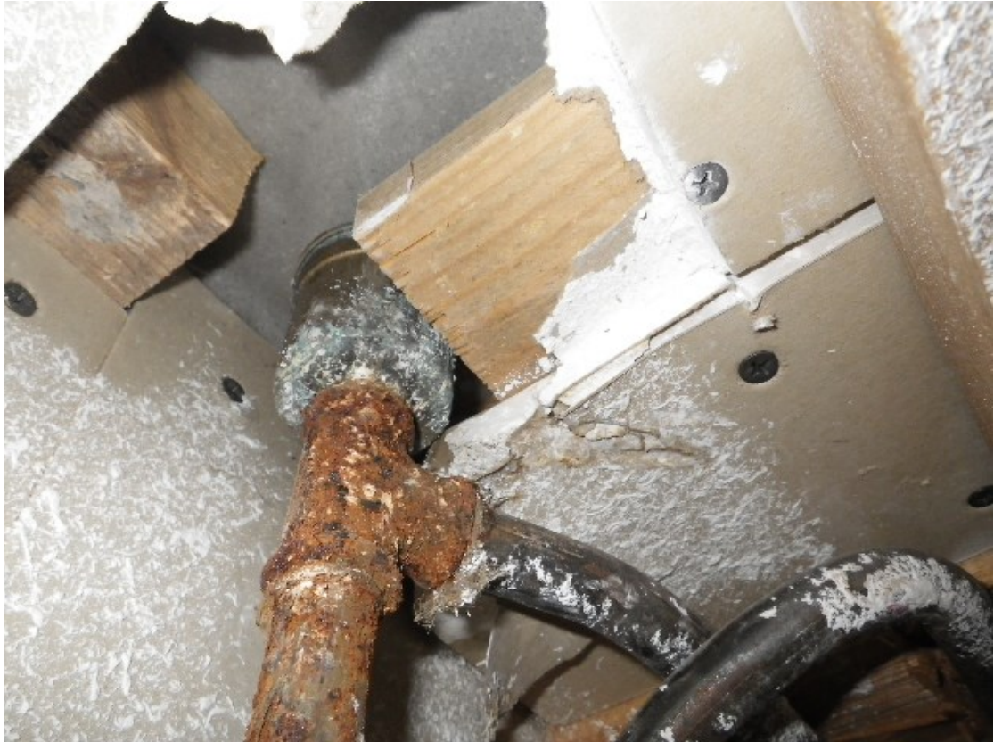
Kuva 28. Automaattinen ilmakello, joka on vuotanut verhokotelossa hitaasti pidemmän aikaa, ruostuttaen putken osat.
