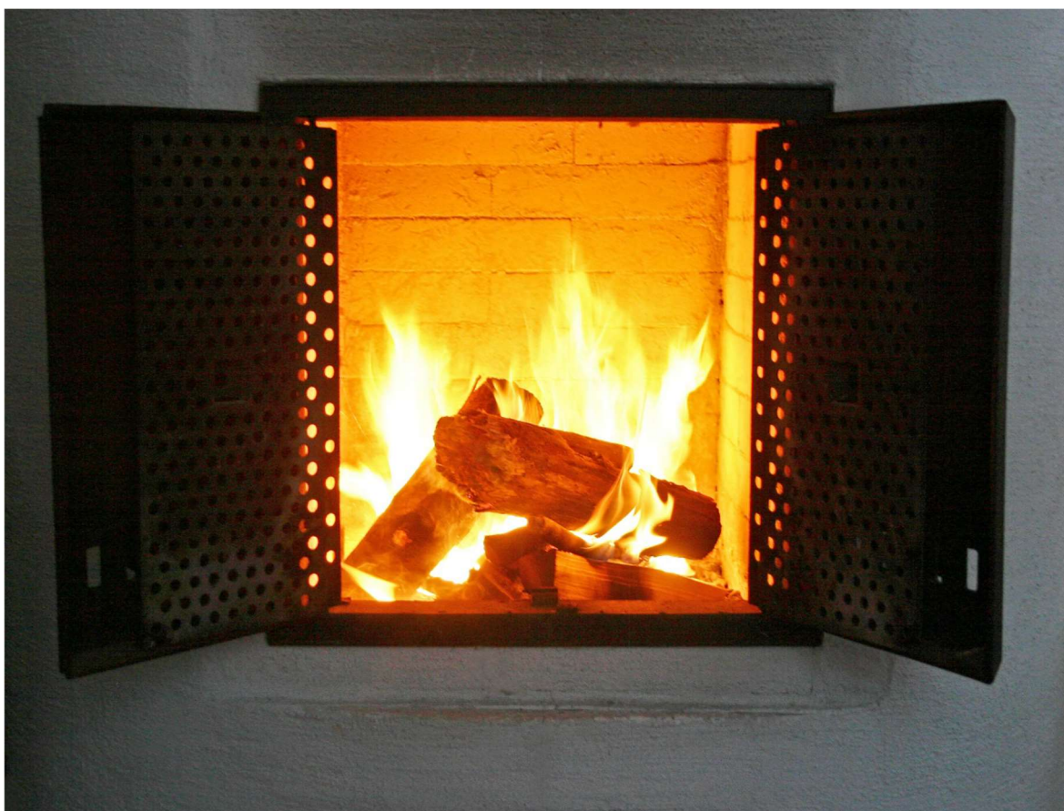
Kuva 8. Takkauunin tulipesä (Savupiipun rakenteet ja paloturvallisuus 2019, 1)
