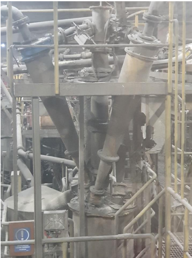
KUVA 1. Kuvassa tutkinnan kohteena olleet hydrosyklonit SC4–6SK
