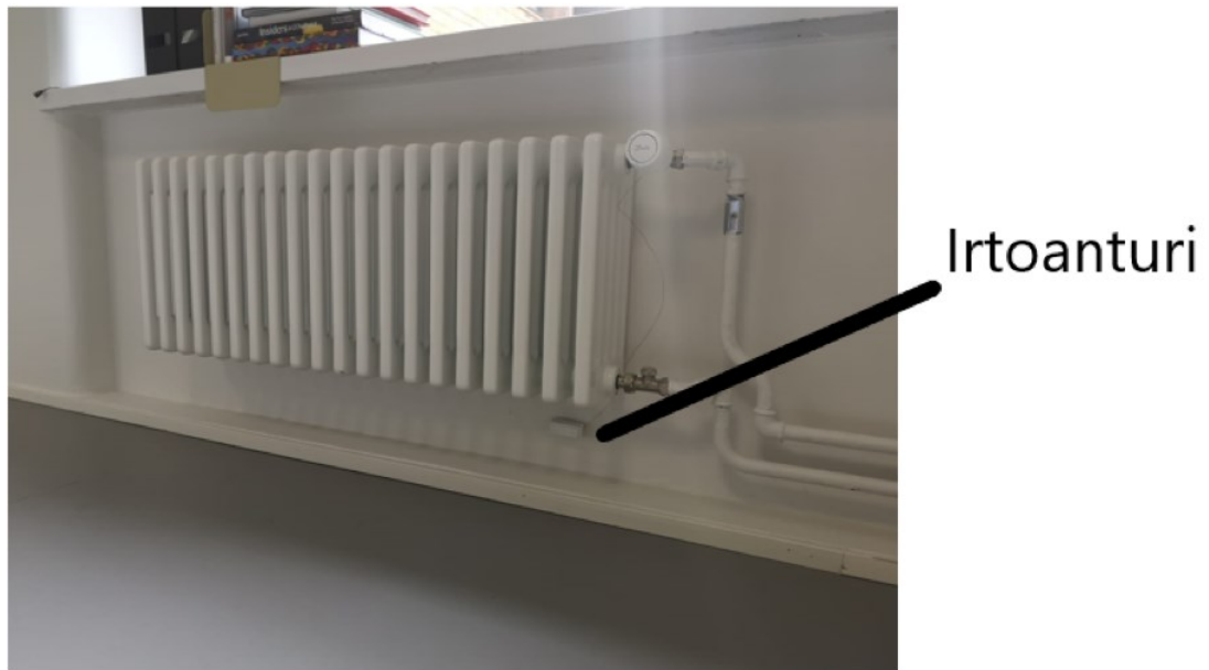
Kuva 4. Irtoanturilla varustettu patteritermostaatti
