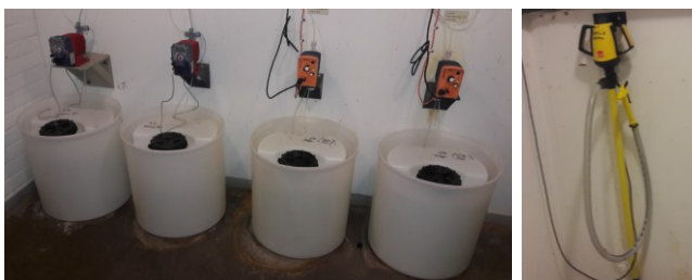
Kuva 22. Kemikaalien syöttöpiste ja siirtopumppu
