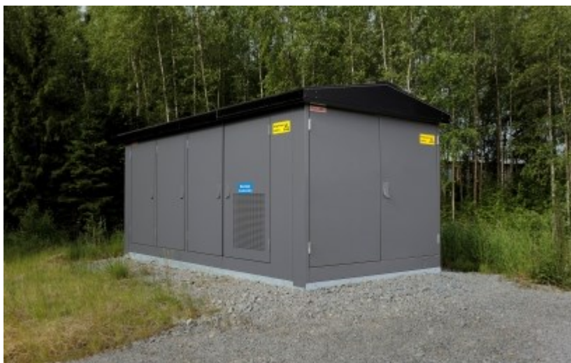
KUVA 2. Alfen Elkamo 20/0,4 kV puistomuuntamo. (Alfen Elkamo, ei pvm.)
