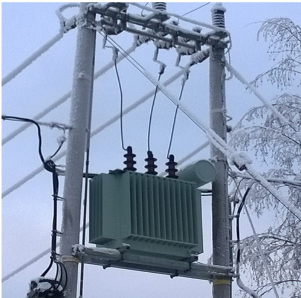
KUVA 3. 20/0,4kV pylväsmuuntamo. (Elenia, 8.12.2017)
