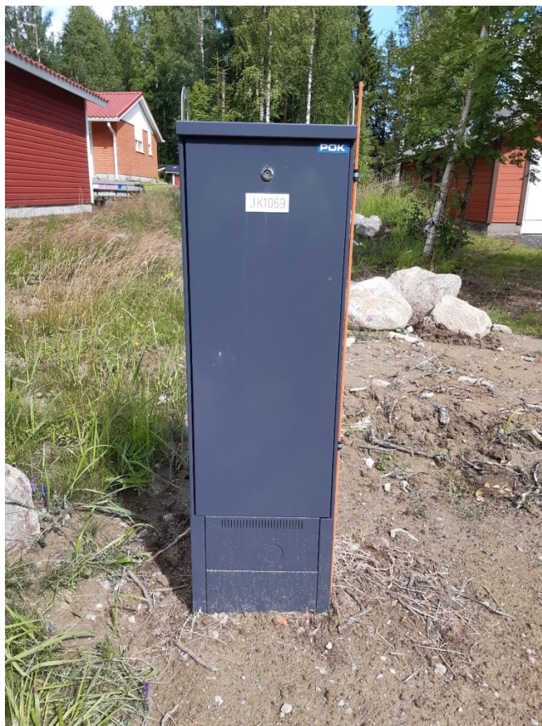
KUVA 18. Yleiskuva jakokaapista ulkoa.
