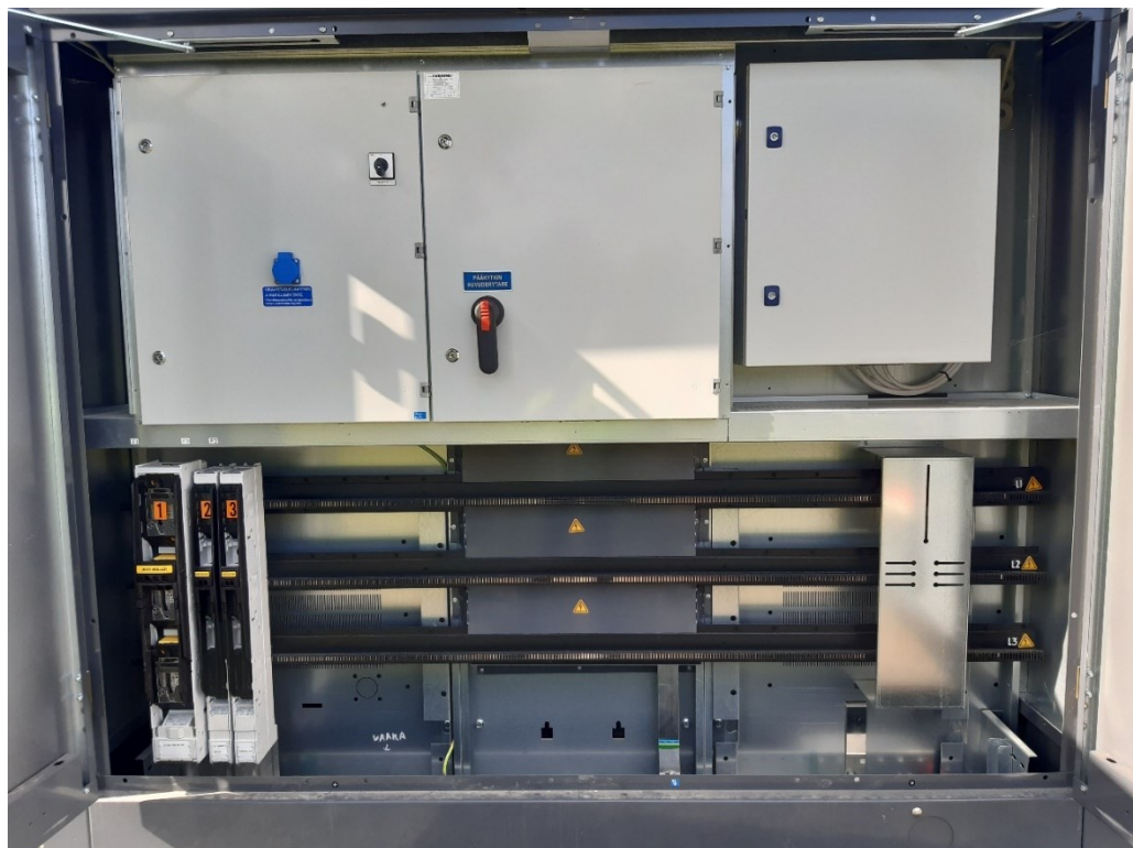
KUVA 10. Yleiskuva muuntamon PJ-tilasta.
