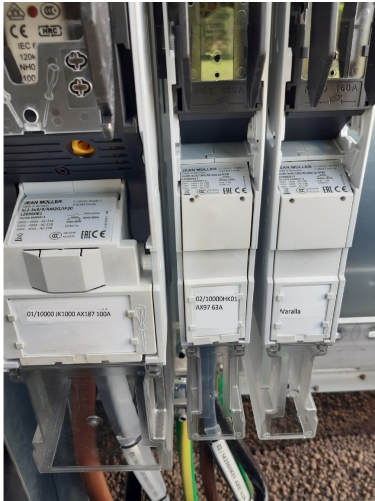
KUVA 12. Muuntamon jonovarokeytkimien tiedot.
