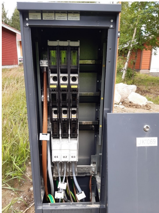
KUVA 19. Yleiskuva jakokaapista sisältä.
