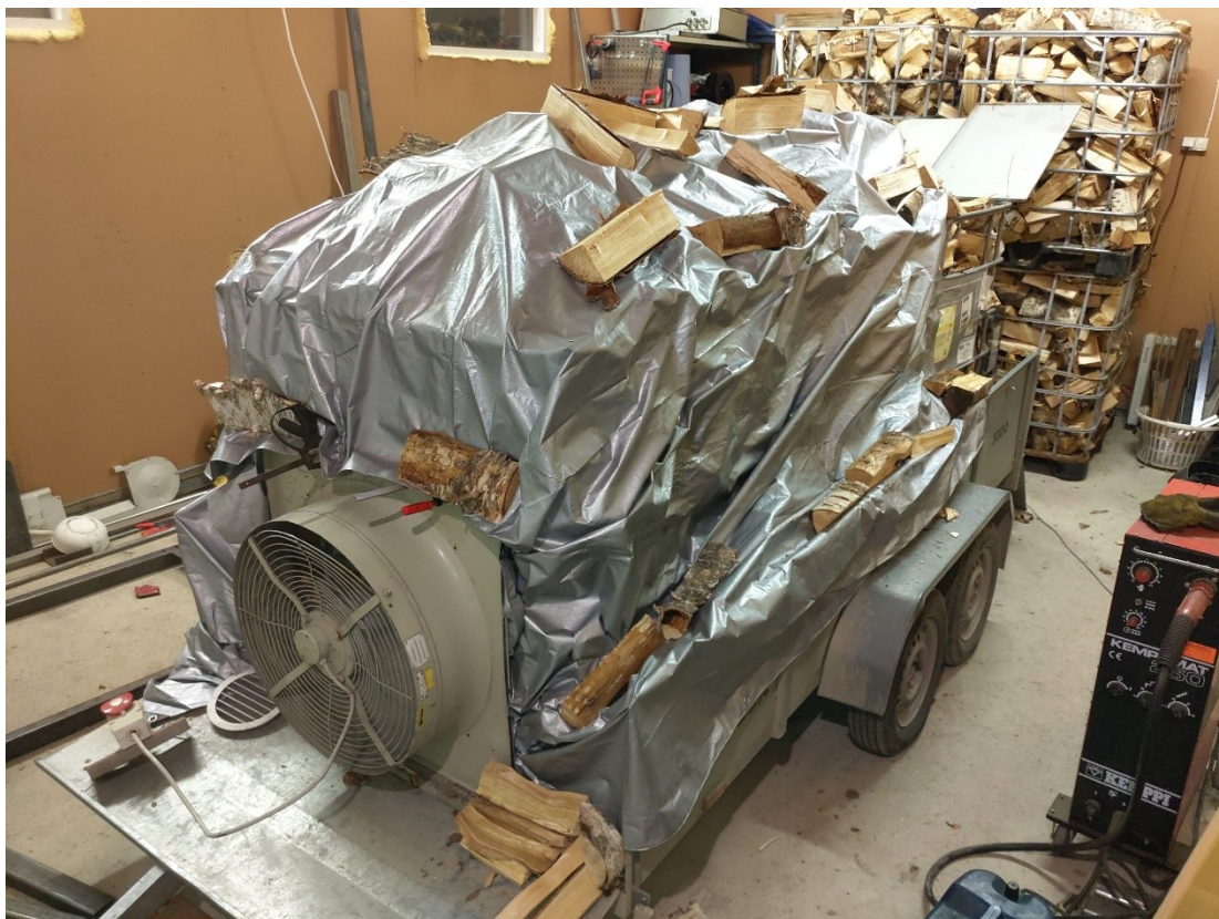
Kuva 6. Kuivausperävaunu ja puhallin
