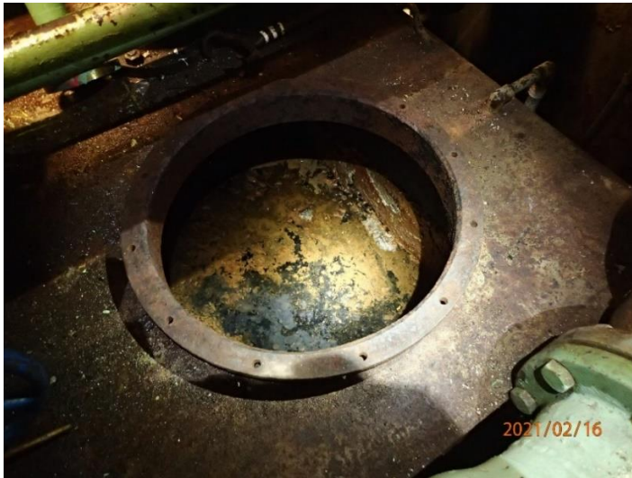
Kuva 6. NFA-2-säiliön avattu kulkuaukko. Jo kulkuaukolta voidaan havaita säiliön sisäpuolista korroosiota.
