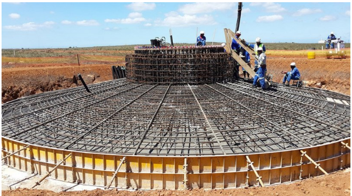
Kuva 4. Maanvarainen tuulivoimaperustus (Engineer News 2014)
