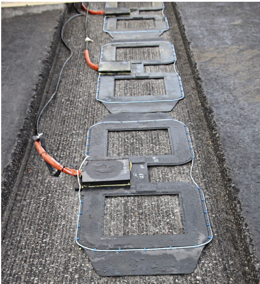
Kuva 13. Maan alle asennettava induktiivinen latausjärjestelmä (Puolakka 2020).
