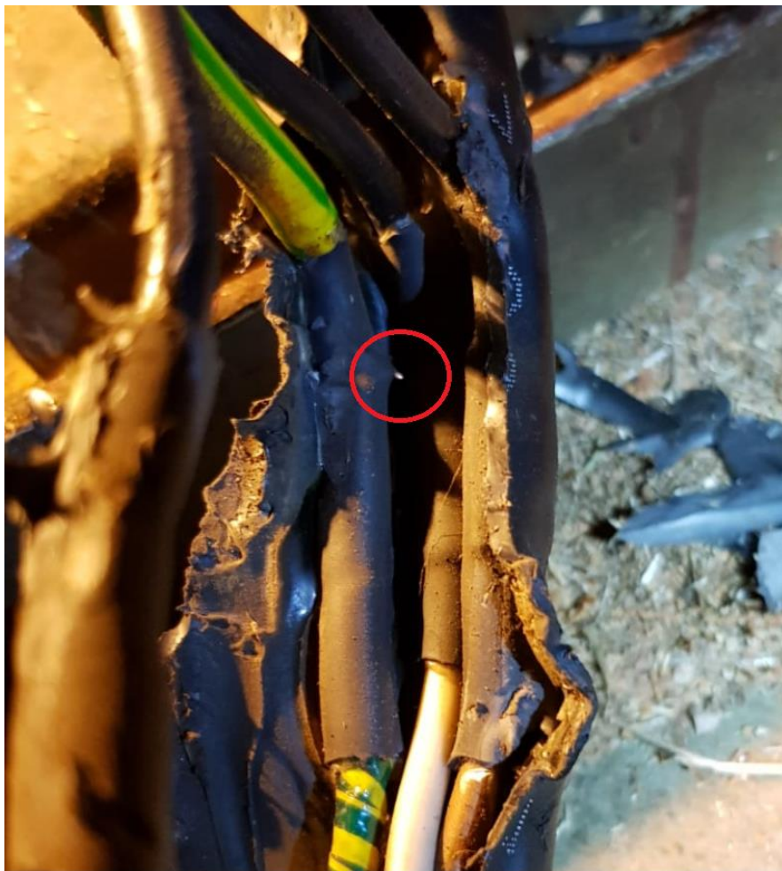
Figur 16. Tråden som pekade ut ur jordledaren och var intryckt i isoleringen på fasledaren L2.
