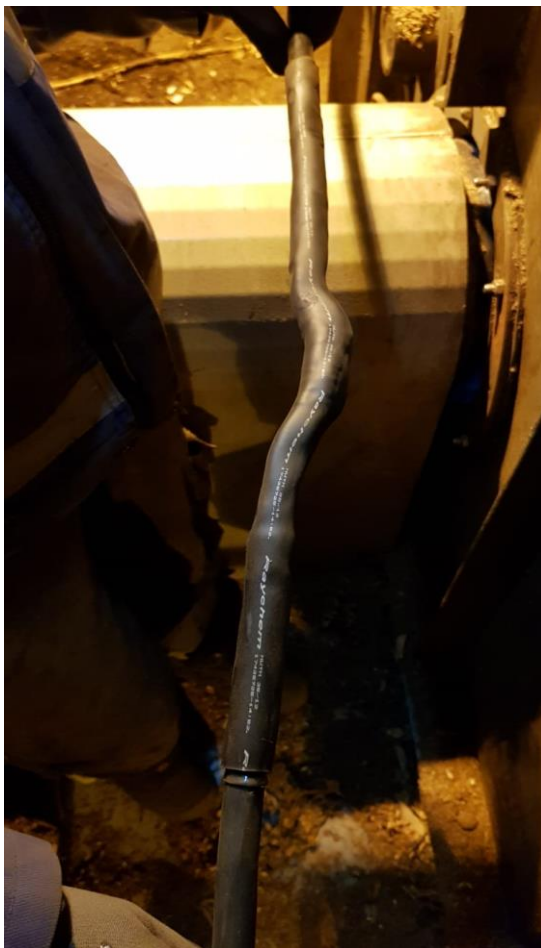
Figur 15. Skarven på kabeln till sållets drivmotor 2.
