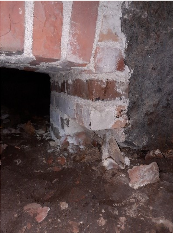
Kuva 14, Rapautunut tiilimuuraus työhuoneen alapohjassa.
