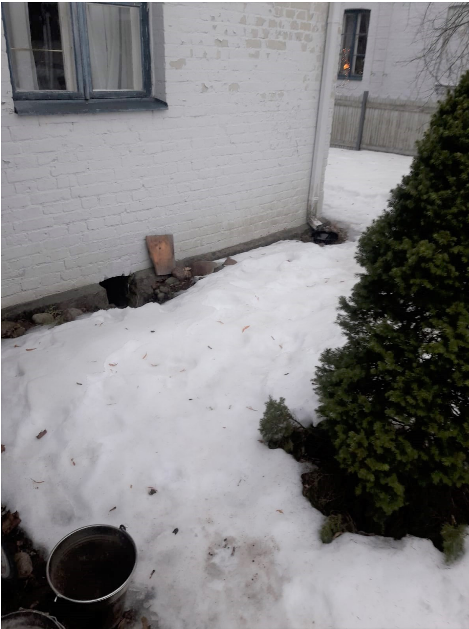
Kuva 13, Työhuoneen seinustan tuuletusaukko on osittain maanpinnan alla.
