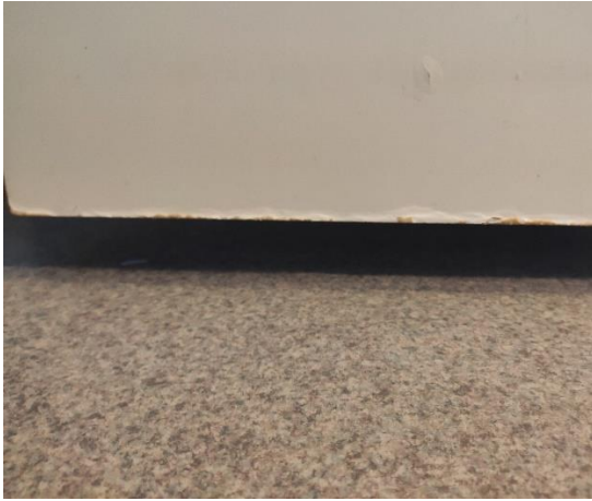
Kuva 28: Kosteusvauriot kylpyhuoneen ovelsa
