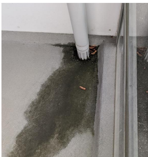
Kuva 20: Vesi ei poistu parvekkeelta
