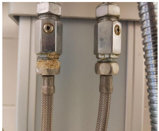
Kuva 38: Kalkki vesiputken liitoksessa
