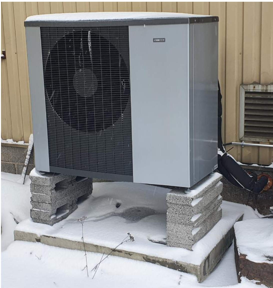
Kuva 16. Nibe F2120-16 asennettuna.
