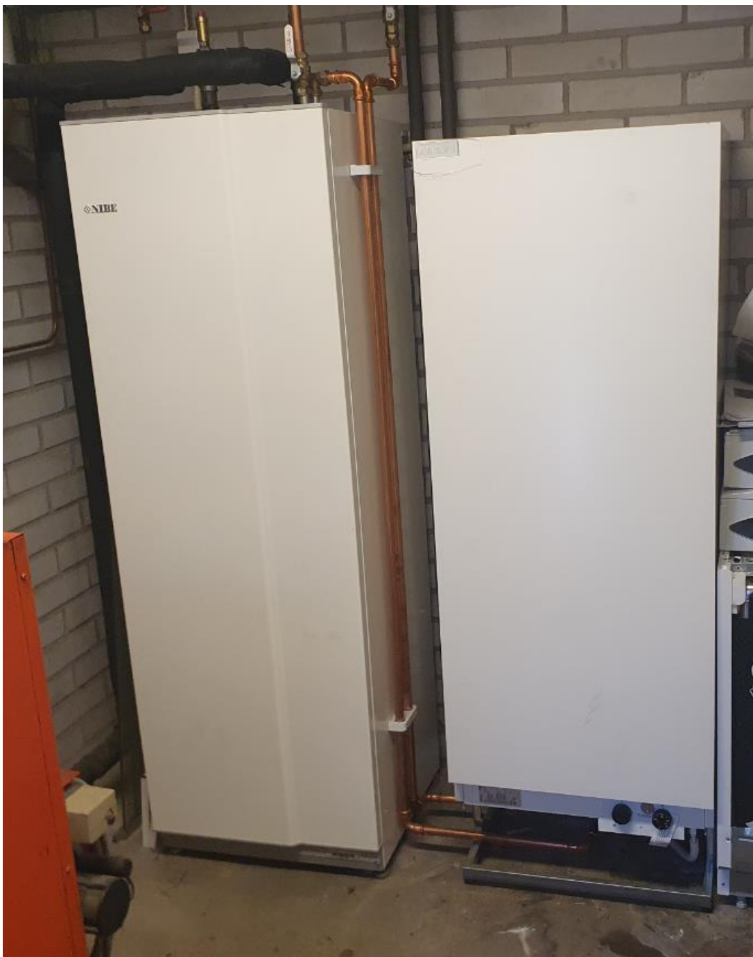
Kuva 15. Puskurivaraaja ja lämminvesivaraaja asennettuna.
