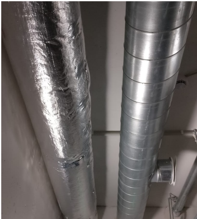
Kuva 6. Vasemmanpuoleinen kanava on eristetty alumiinilaminaatilla päällystetyllä lämpöeristeellä. Oikealla on eristämätön kierresaumakanava.
