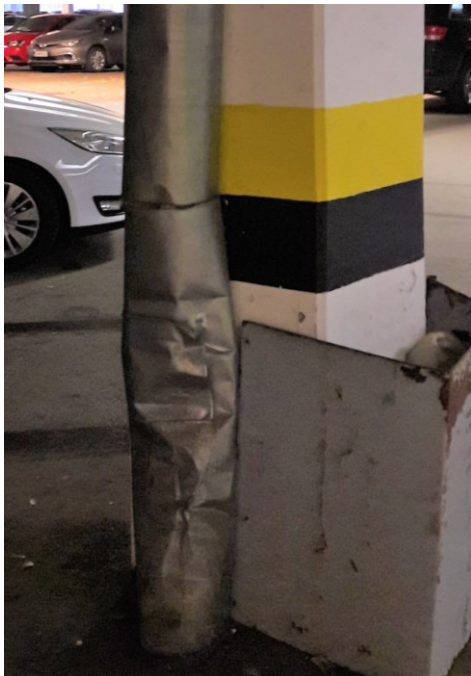
Kuva 9. Parkkihallissa oleva runneltu eristetty putki.
