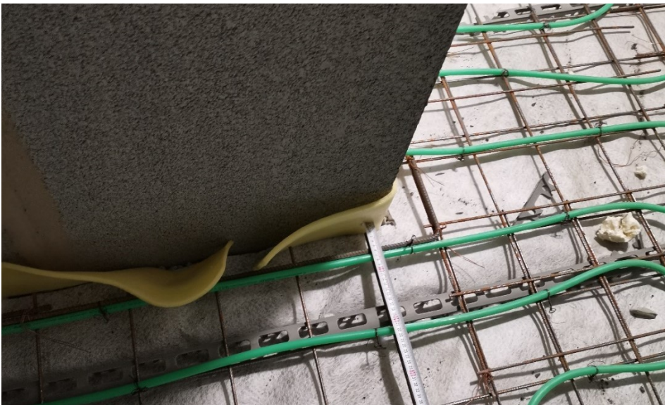
Kuvio 2 Irroituskaisista asennettu virheellisesti.
