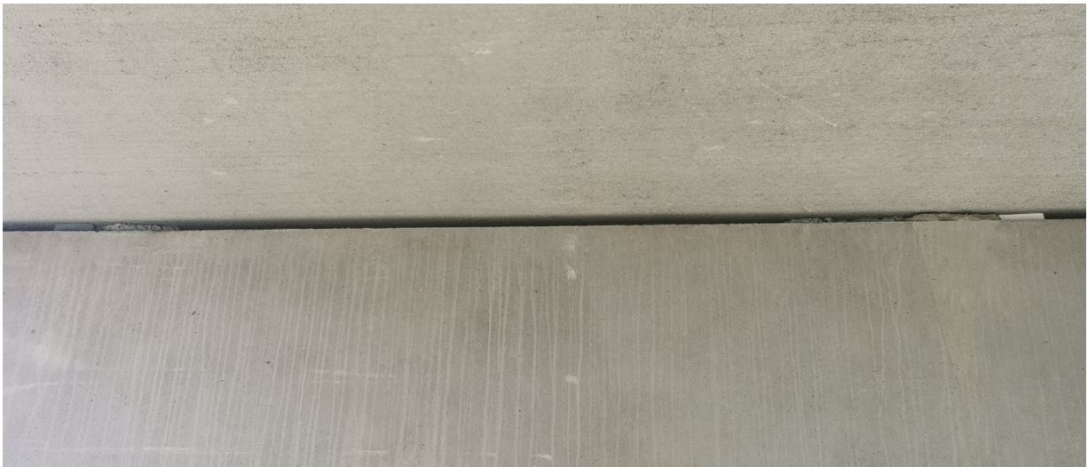
Kuvio 1 Sauman täyttö vajaa parvekerakenteissa.
