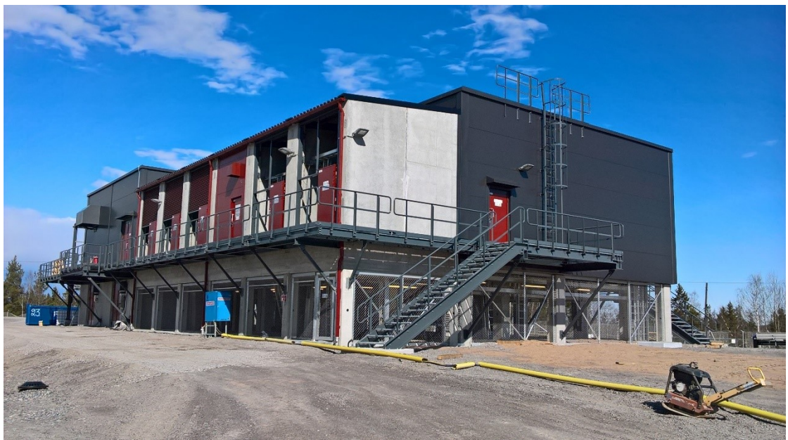
Kuva 10. Teollisuuden muuntamorakennus. Betoniset muuntajabunkkerit etualalla (Nieminen 2015)
