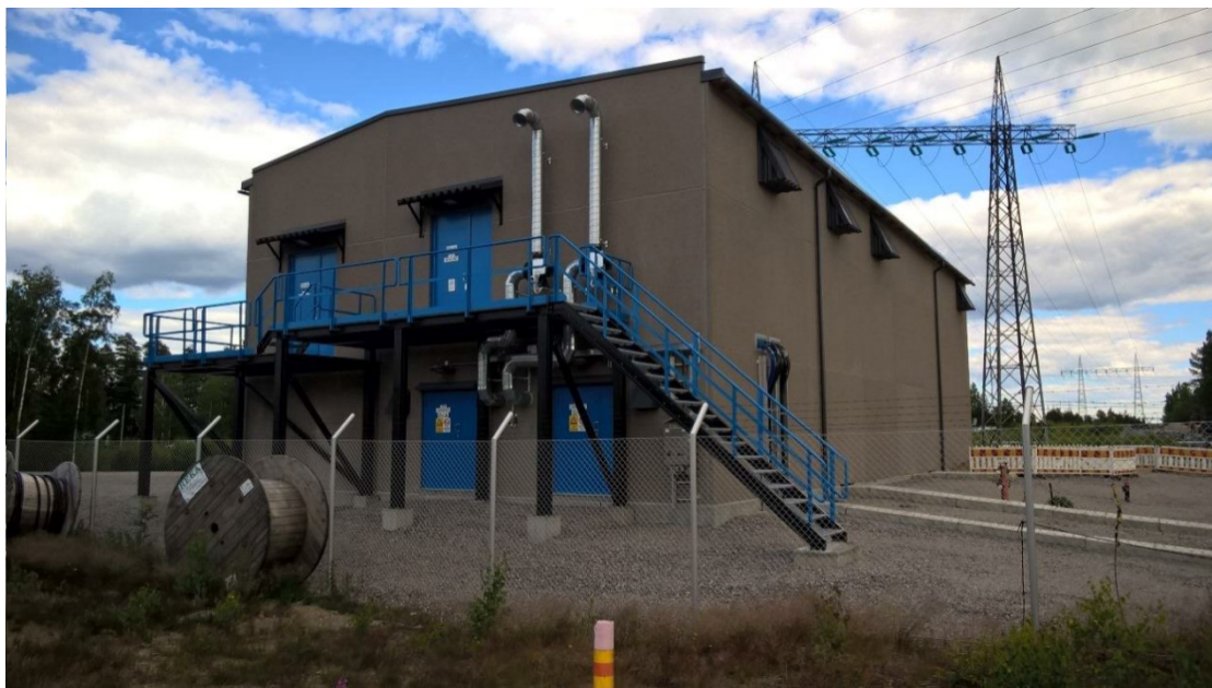
Kuva 8. Betonielementtirakenteinen muuntamorakennus (Nieminen 2019)
