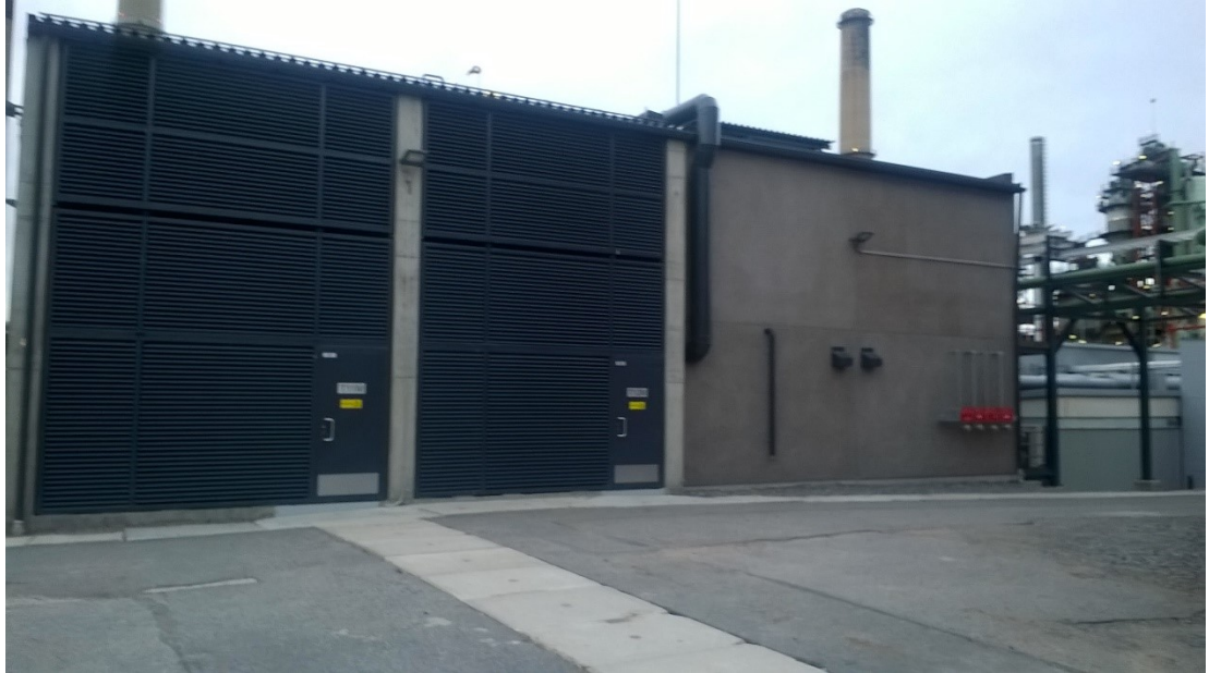
Kuva 9. Suurjännitemuuntajien bunkkerit (Nieminen 2019)
