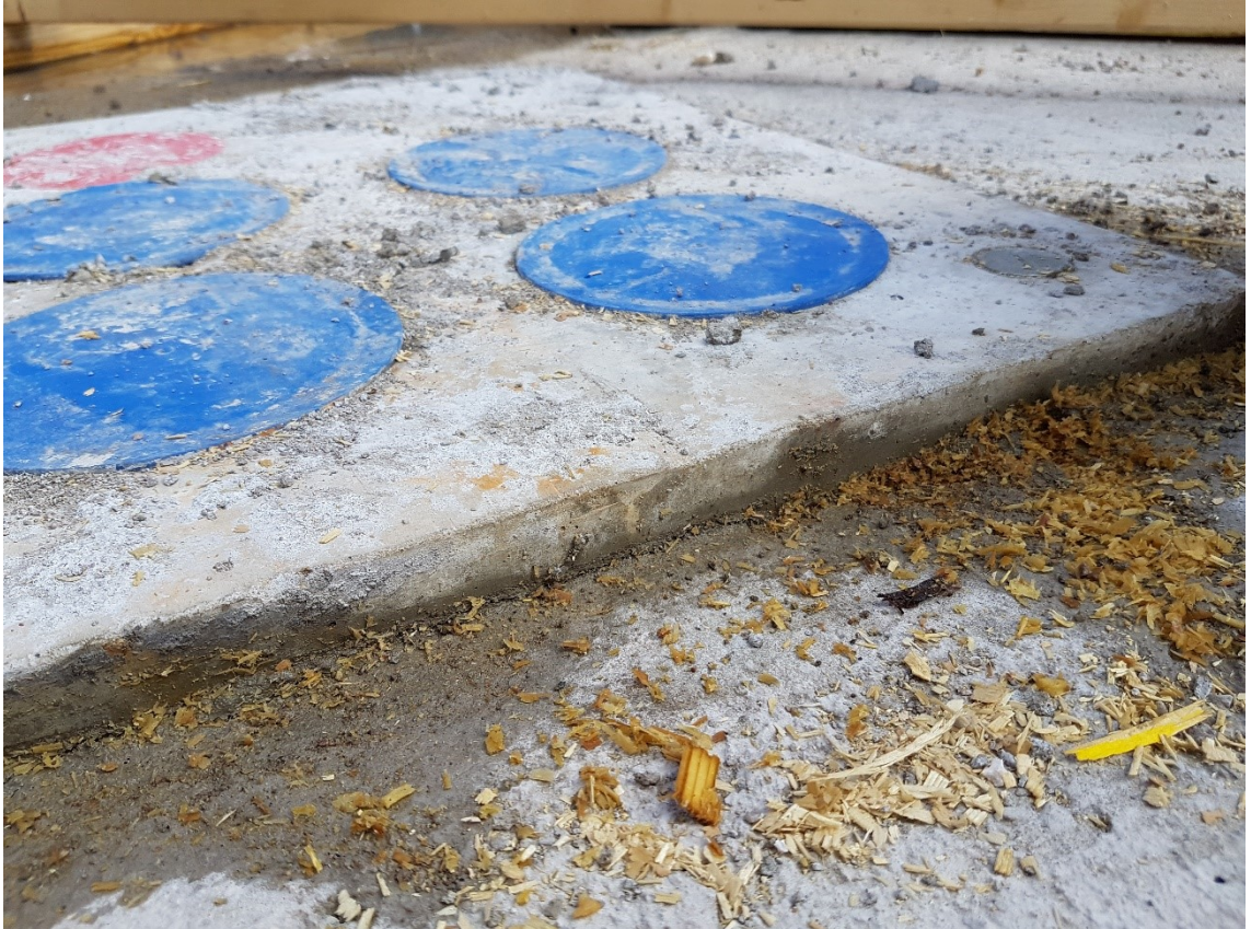
Kuva 11. Talotekniikkaelementti, korkoasema valetun holvin yläpinnan yläpuolella.
